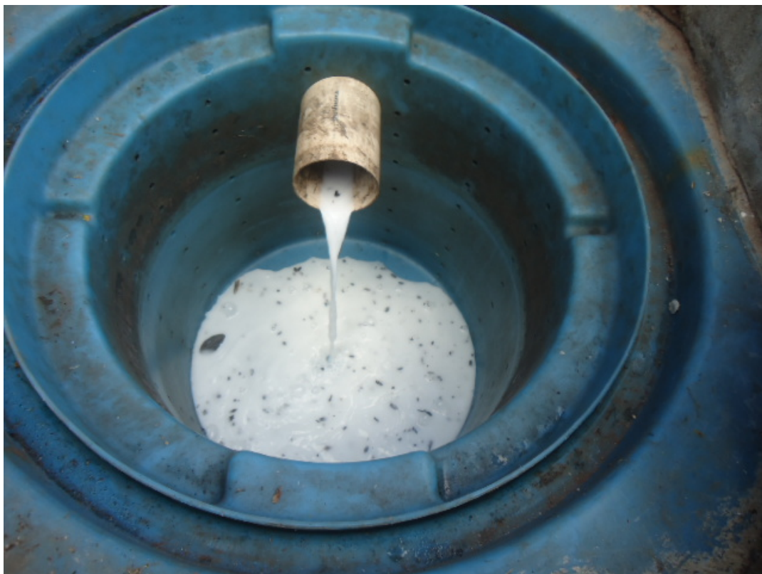
Foto 11 – Caixa de areia do Sistema Separador de Água e Óleo da pista de abastecimento. Observa-se que o sistema está em pleno funcionamento em função do teste que foi realizado com corante nas canaletas do sistema de drenagem oleosa - SDO da pista de abastecimento.
