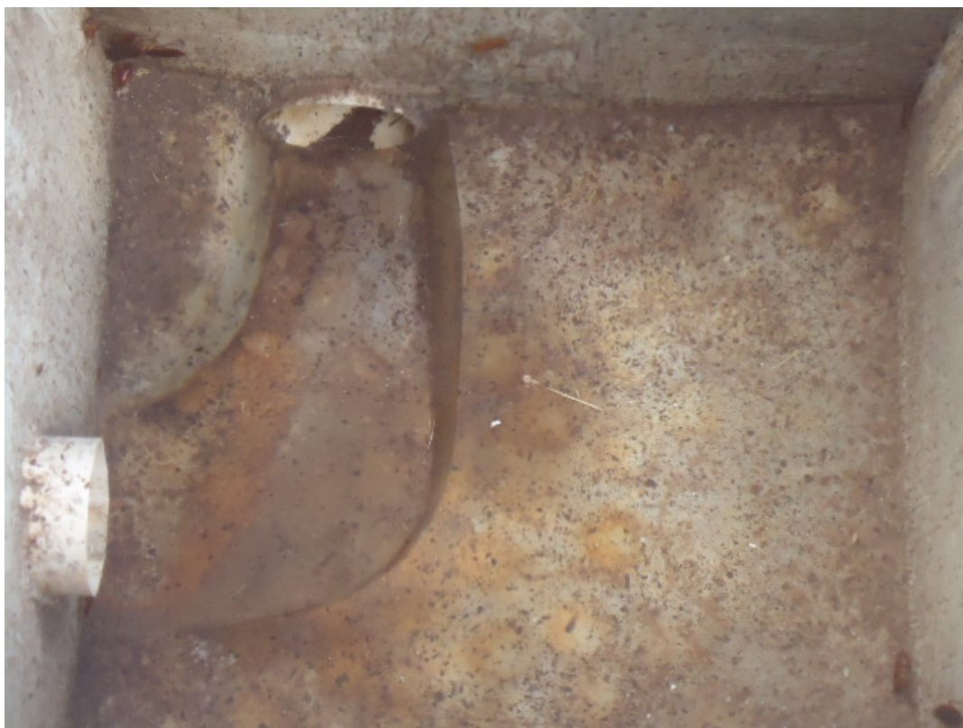
Foto 13 – Caixa de amostragem de efluentes da pista de Abastecimento.
