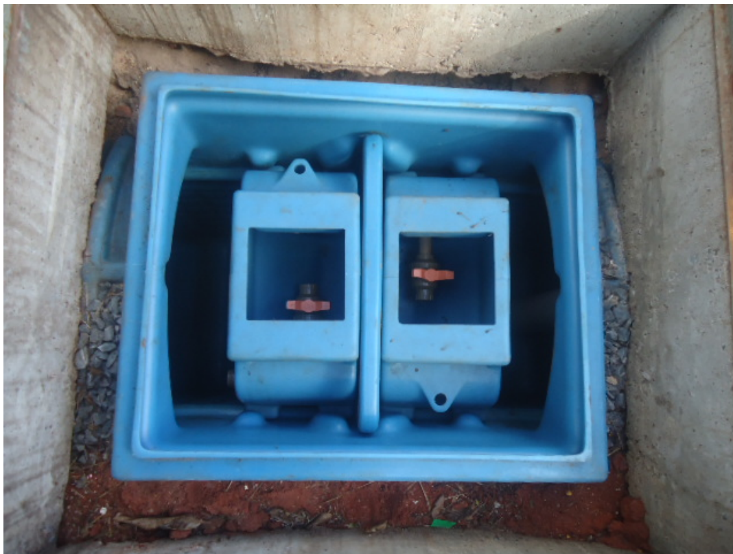
Foto 12 – Caixa Separadora de água e óleo do SAO da pista de abastecimento.
