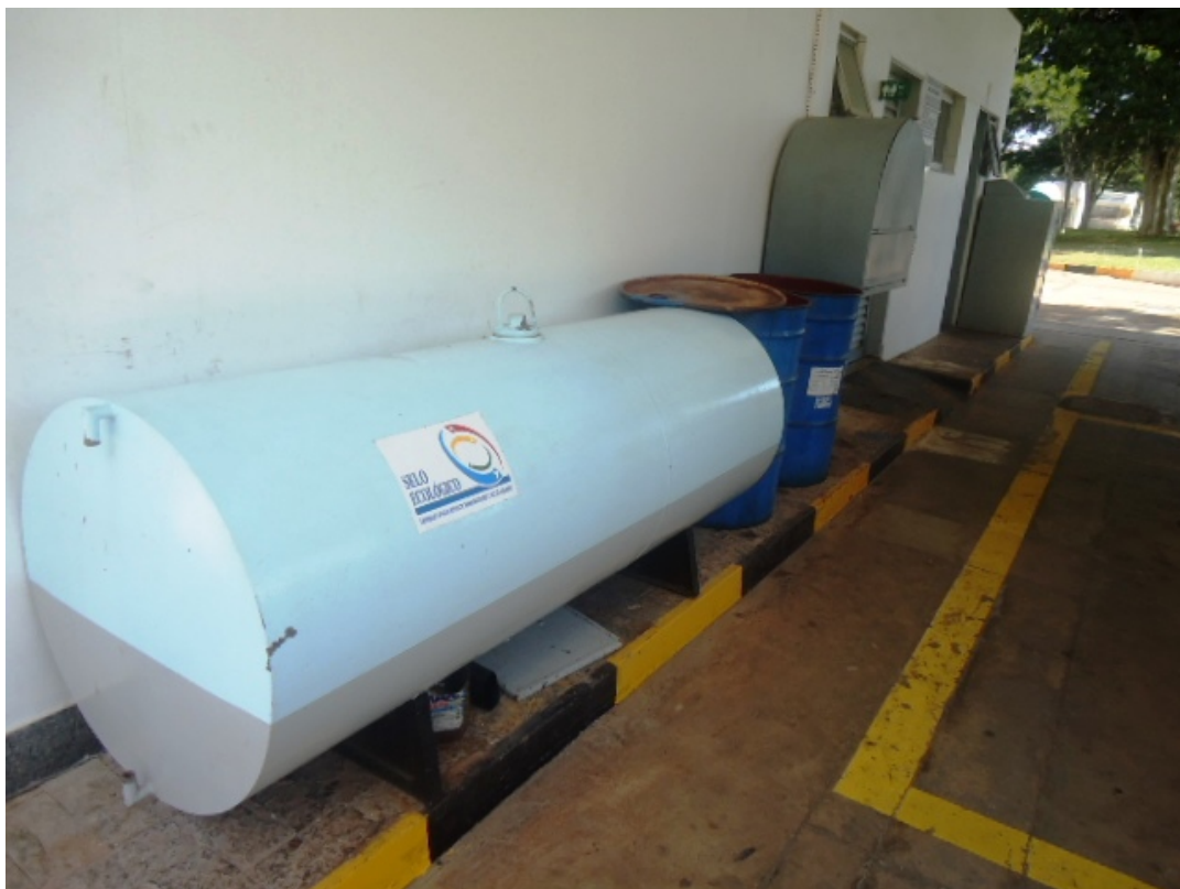
Foto 7 – Aspecto do tanque Aéreo de óleo Usado e Contaminado - OLUK e dos tambores para a segregação dos resíduos perigosos classe 1.
