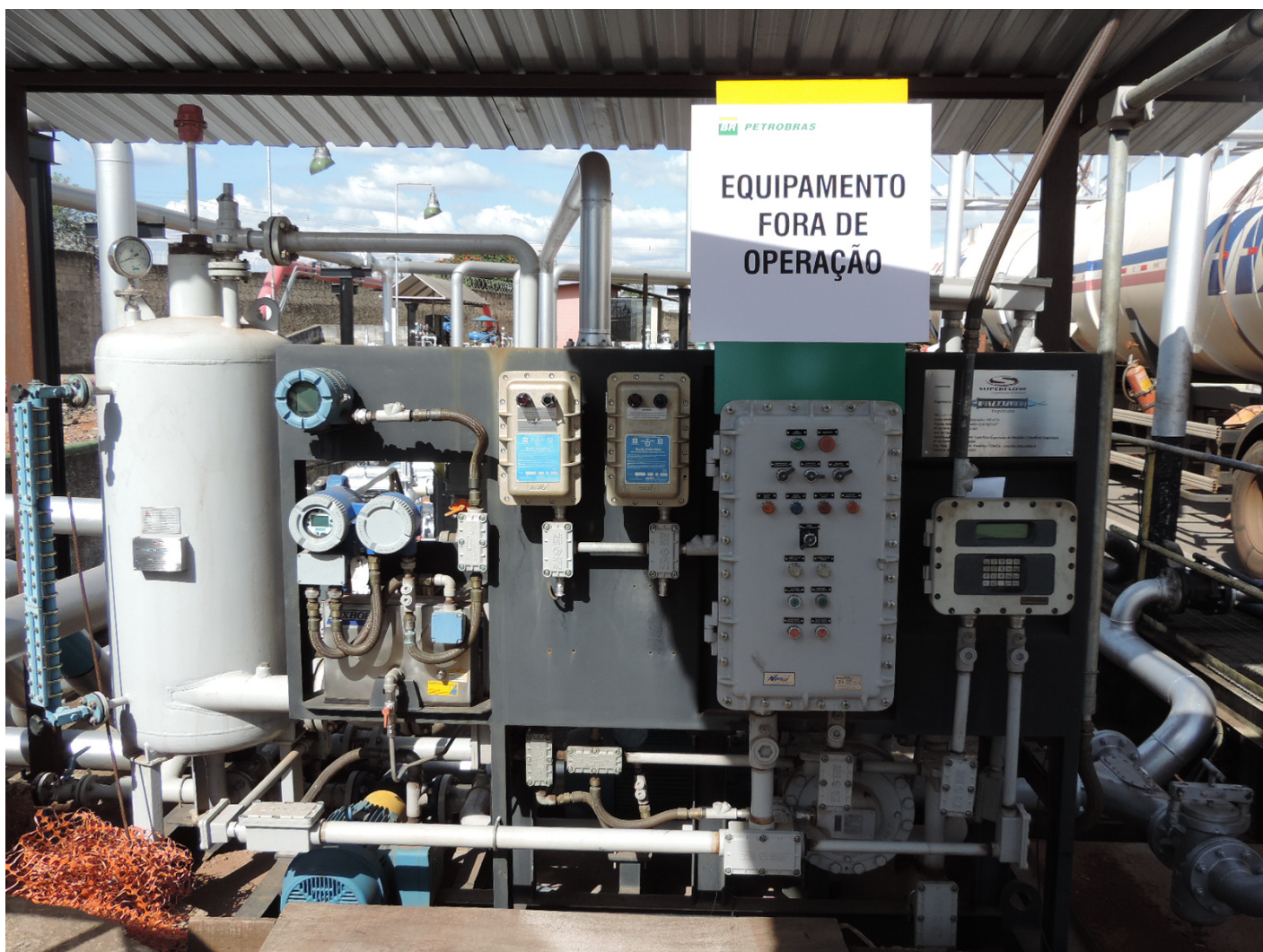
Figura 03 - SKID de descarga de caminhão tanque em instalação.
