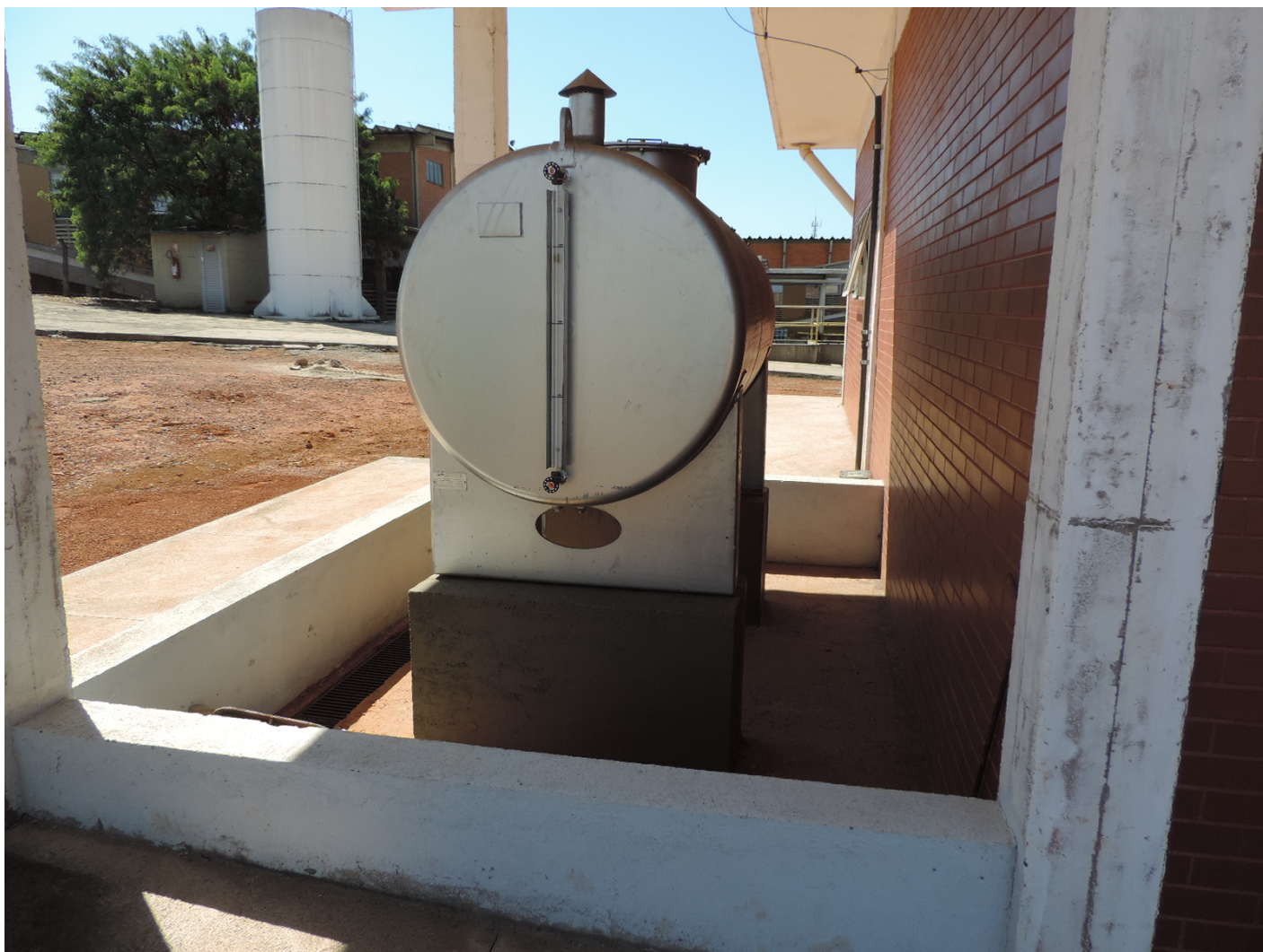
Figura 04 - Tanque para armazenamento de diesel da Subestação SE - III.
