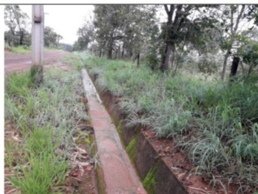
Foto 11 – Sistema de drenagem existente.
