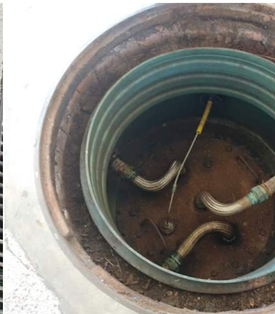
Foto 6. Câmara de contenção de um dos tanques subterrâneos de armazenamento
