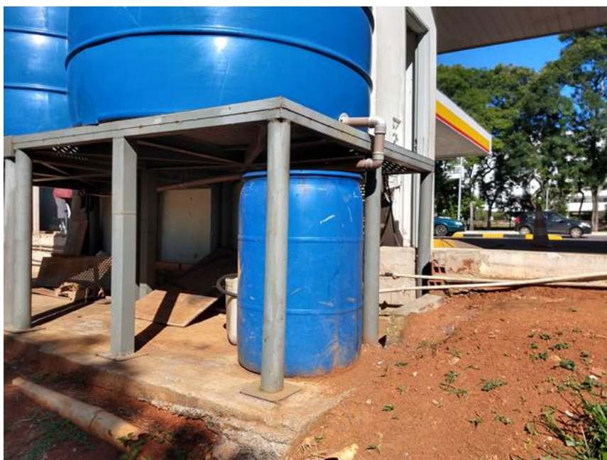
Foto 11. Resíduos dos SAO armazenados em local incorreto.
