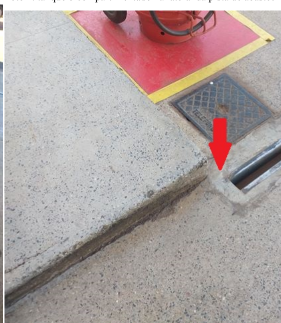
Foto 4. Canaleta da pista de abastecimento instalado de forma incorreta
