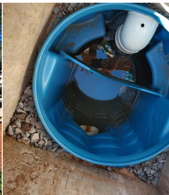
Foto 12. Caixa de amostragem do SAO da pista de abastecimento
