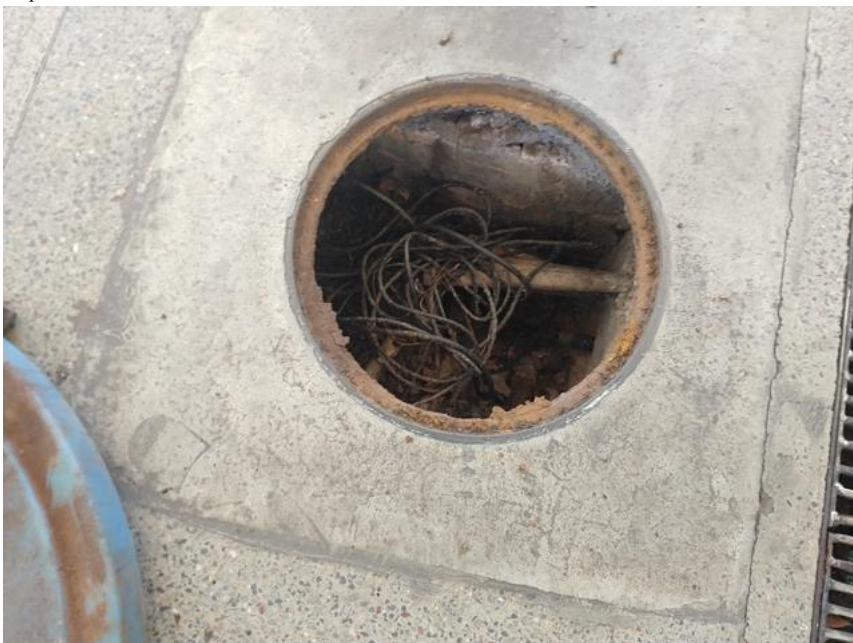
Foto 5. Caixa de passagem de fiações, sem canaletes ao redor.
