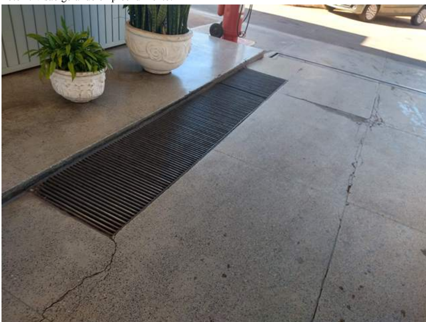
Foto 3. Fissuras na pista e grelha não circundada por canaletes, que permite acesso ao subsolo do empreendimento.
