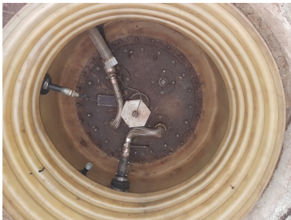
Foto 1. Tanque de combustível.
