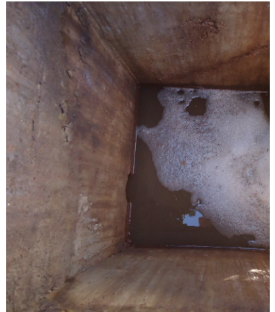
Foto 54: Caixa de areia em concreto do SAO exclusivo da atividade de lavagem de veículos.
