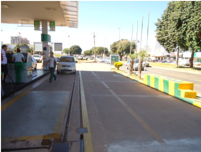
Foto 4: Destaque da abrangência ineficiente do canaleta no outro lado da pista de abastecimento.
