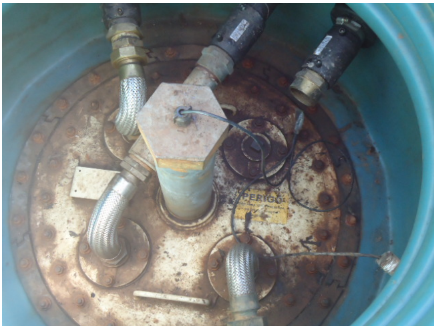
Foto 18: Boca de visita de um dos tanques com câmara de contenção ( sump de tanque). Em destaque, a tubulação (linha de combustível) não conectada ao tanque e não tamponada.
