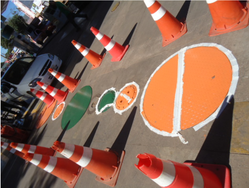
Foto 14: Localização dos tanques subterrâneos de armazenamento de combustíveis – Tanque Tripartido.
