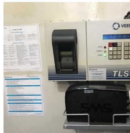
Foto 21: O controle de estoque é realizado eletronicamente e os tanques intersticiais em funcionamento, confirmado no painel eletrônico.
