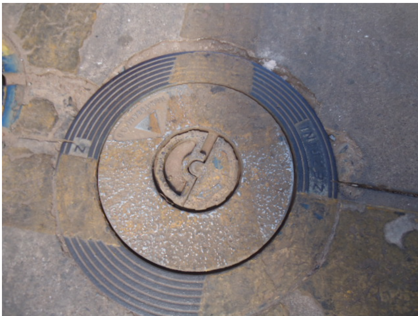
Foto 22: Monitoramento intersticial com câmara de contenção e caixa de passagem
