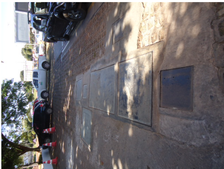
Foto 39: Sistema Separador de Água e Óleo (SAO) da pista de abastecimento, área de lubrificação de veículos e área de descarga à distância.
