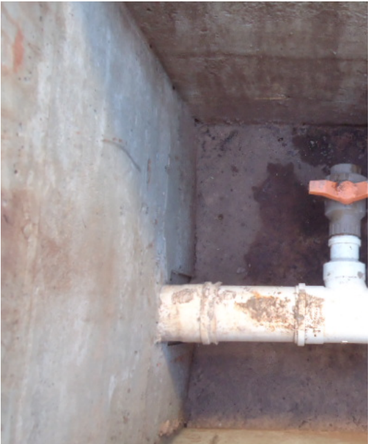
Foto 48: Caixa de amostragem em concreto do SAO da pista de abastecimento e área de descarga à distância.
