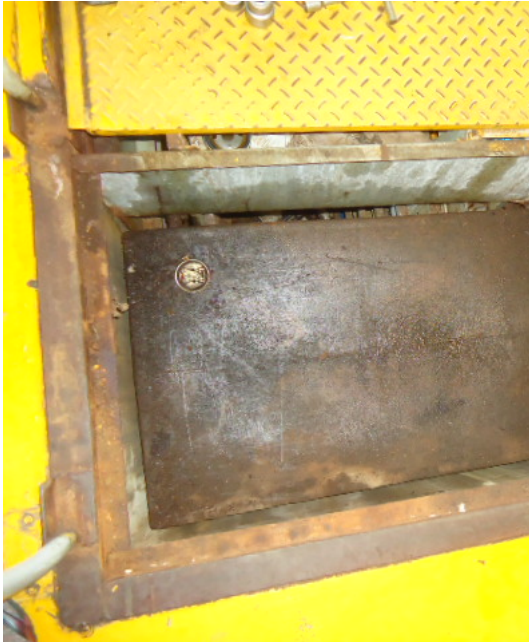
Foto 28: Tanque de polietileno disposto na vala central da área armazenar temporariamente o Óleo de Lubrificação Us
