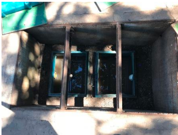
Foto 55: Caixa separadora em polietileno do SAO exclusivo da atividade de lavagem de veículos.
