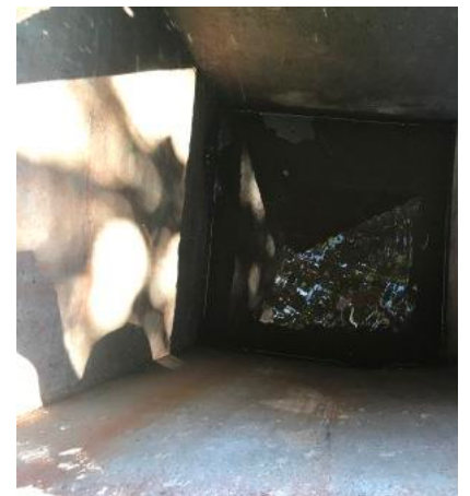
Foto 56: Caixa de amostragem em concreto do SAO exclusivo da atividade de lavagem de veículos.
