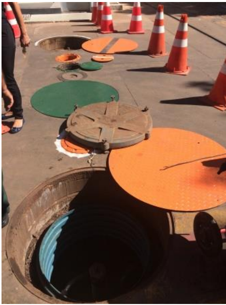
Foto 24: Detalhe dos Tanques, das descargas seladas sobre o tanque e o monitoramento intersticial.
