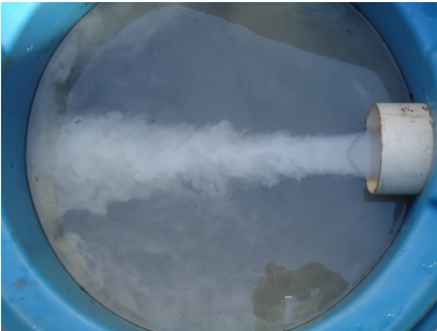
Foto 51: Caixa de areia em pré-moldado do SAO da pista de abastecimento em funcionamento.
