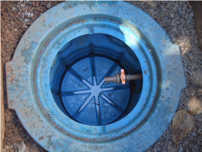
Foto 47: Caixa coletora de óleo em pré-moldado do SAO da pista de abastecimento, área de lubrificação de veículos e área de descarga à distância.
