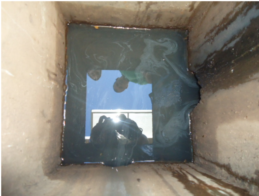
Foto 41: Caixa de areia em concreto do SAO da pista de abastecimento, área de lubrificação de veículos e área de descarga à distância.
