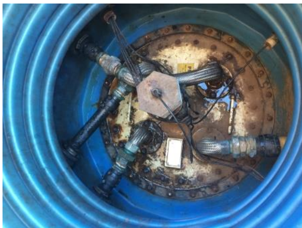
Foto 20: A tubulação subterrânea do SASC é constituída de PEAD.
