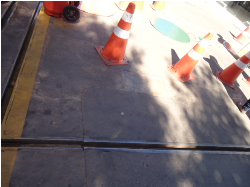
Foto 10: Os canaletes da pista de abastecimento possuem as dimensões necessárias e direcionam os efluentes para o sistema separador de água e óleo (SAO).
