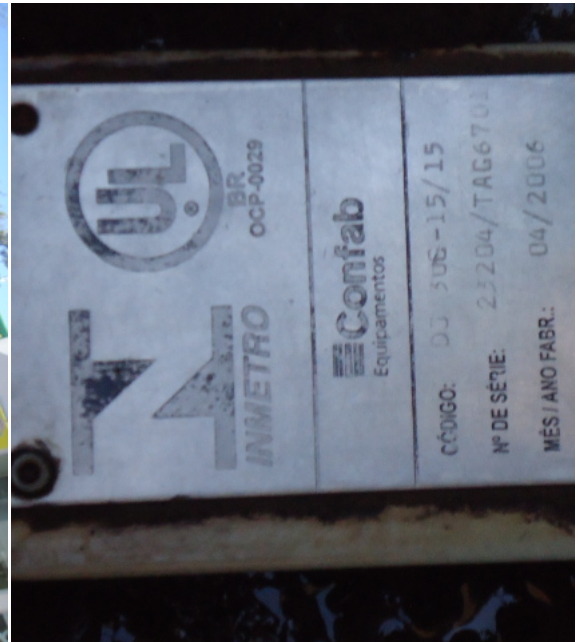
Foto 17: Placa de identificação de um dos tanques subterrâneos.
