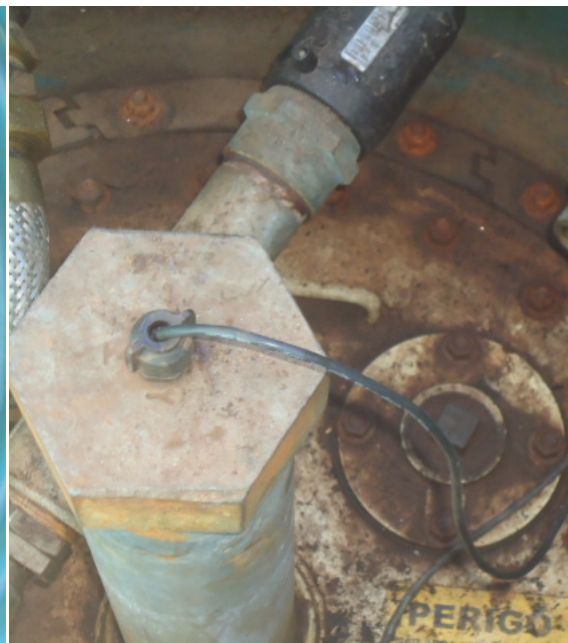
Foto 19: Detalhe da tubulação (linha de combustível) não conectada ao tanque e não tamponada.
