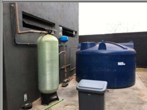
Foto 03: Tanque de armazenamento de água.
