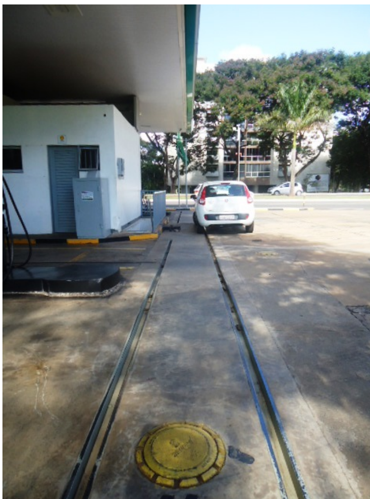
Figura 5 - Canaletas Internas do Sistema de Drenagem Oleosa -SDO e externas da drenagem de águas pluviais da área de abastecimento com recuo interno de 0,5 metros conforme exige o item 4, da ABNT NBR 14.605-2:2010.
