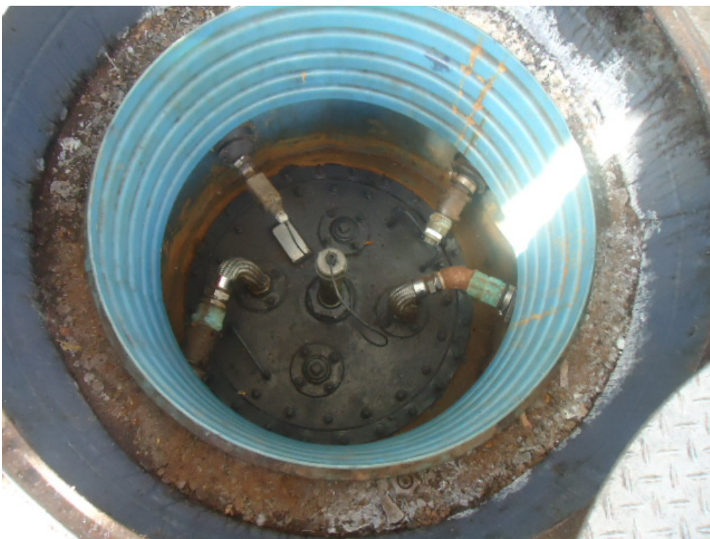
Figura 22 - Aspecto do acesso a boca de visita de um dos 6 (seis) conjuntos de tanque de parede simples do Sistema de Armazenamento Subterrâneo de Combustíveis - SASC. Observa-se que o tanque possui controle eletrônico de estoque.
