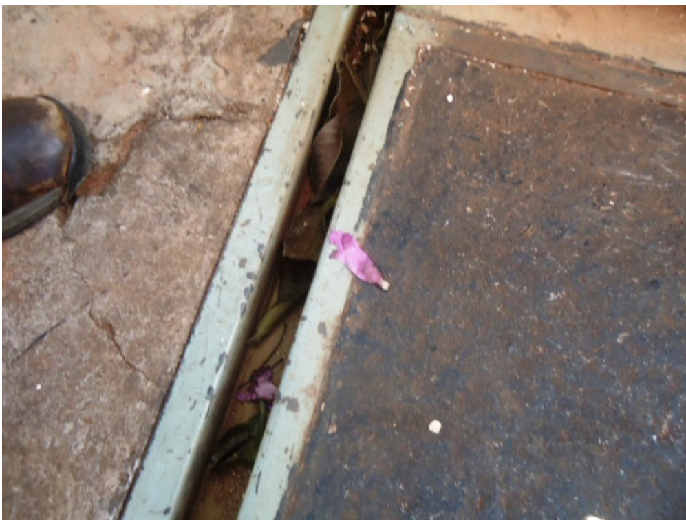
Figura 7 - Canaletas da área da pista de abastecimento. Observa-se o acúmulo de resíduos (folhas secas) em sua estrutura interna. Observa-se o acúmulo de resíduos (folhas secas) na estrutura interna do dispositivo. A tabela 2 da ABNT NBR 15594-3:2008 exige a verificação e manutenção dos sistemas.
