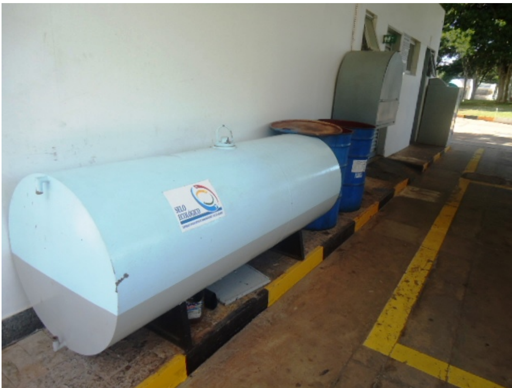
Figura 6 - Aspecto do tanque Aéreo de óleo Usado e Contaminado - OLUC e dos tambores para a segregação dos resíduos perigosos classe 1. Observa-se que o tanque está em local coberto e cercado por canaletas da área da pista de abastecimento conforme exige o art. 22 da instrução 213 de 2013.
