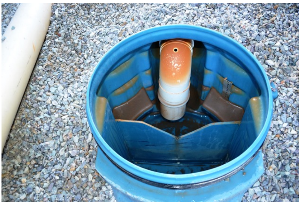
Figura 15 - Aspecto do Módulo de Inspeção de Efluentes - MIE do SAO da pista de abastecimento. O sistema instalado se encontra fora de operação e quando entrar em operação deverá realizar manutenção operacional semanal conforme exige a tabela 1 da ABNT NBR 15594-3:2008.
