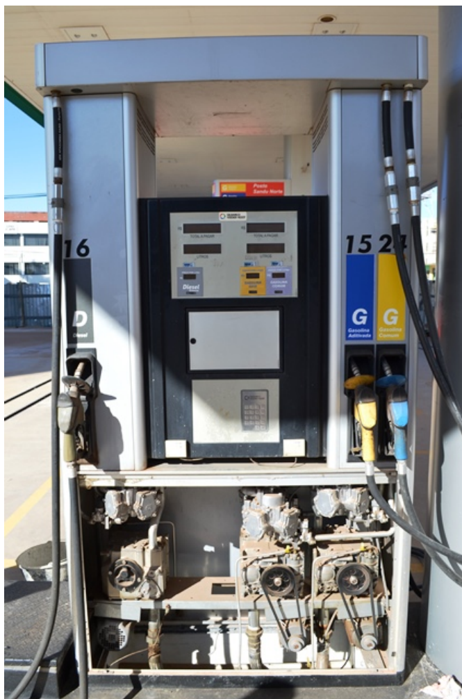
Figura 3 - Unidade abastecedora de Gasolina Comum e Aditivada com o dispositivo de segurança check-valve , observa-se que a tubulação está limpa e totalmente contida na câmara de contenção para unidade da bomba.
