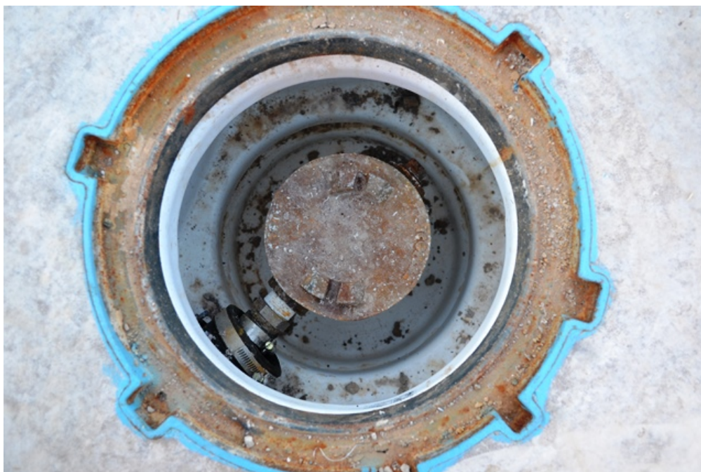
Figura 15 - Detalhe da câmara de contenção interna do Monitoramento do Interstício. Observa-se que o dispositivo necessita de manutenção operacional constante conforme exige a tabela 1 da ABNT NBR 15594-3:2008.
