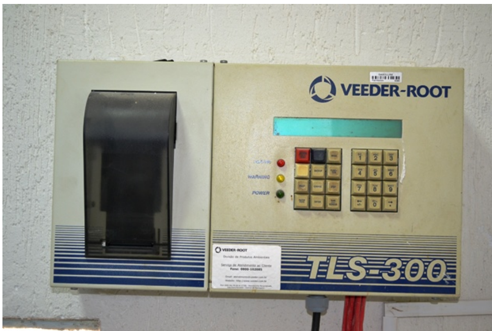
Figura 15 - Sistema de medição e monitoramento ambiental Veeder-Root. O sistema está instalado e não se encontra em operação.
