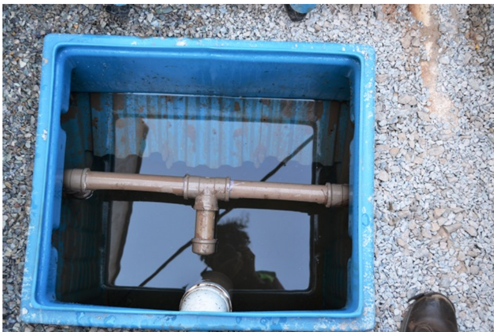
Figura 15 - Aspecto de um dos compartimentos da Caixa Separadora de Água e Óleo - CSAO do SAO da pista de abastecimento. O sistema instalado se encontra fora de operação e quando entrar em operação deverá realizar manutenção operacional semanal conforme exige a tabela 1 da ABNT NBR 15594-3:2008.
