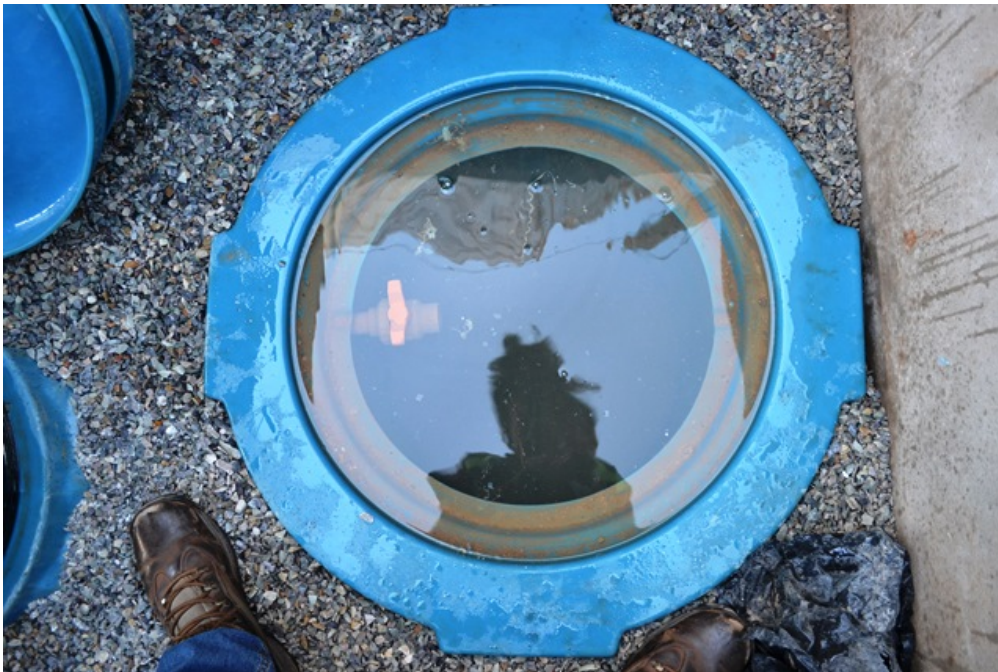
Figura 15 - Aspecto do Módulo de Coleta de Óleo - MIE do SAO da pista de abastecimento. O sistema instalado se encontra fora de operação e quando entrar em operação deverá realizar manutenção operacional semanal conforme exige a tabela 1 da ABNT NBR 15594-3:2008.
