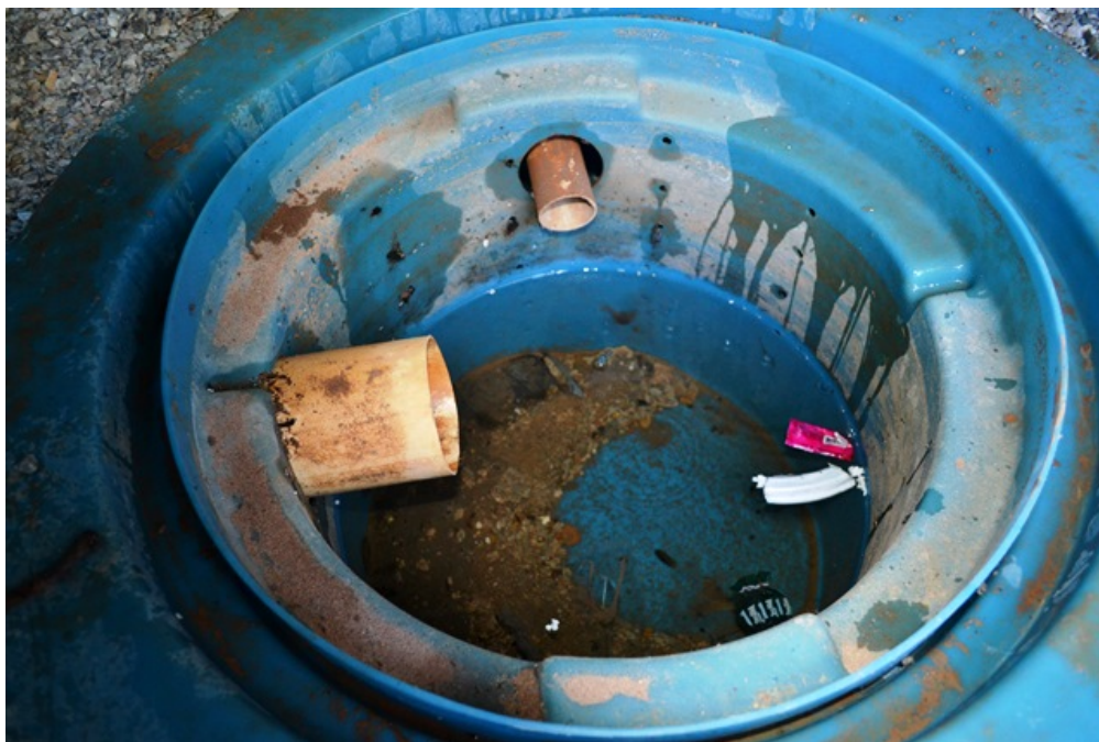
Figura 15 - Aspecto da Caixa de Inspeção com Filtro, Módulo Pré-Filtro (MPF) do SAO da pista de abastecimento. O sistema instalado se encontra fora de operação e quando entrar em operação deverá realizar manutenção operacional semanal conforme exige a tabela 1 da ABNT NBR 15594-3:2008.
