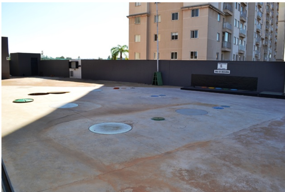
Figura 9 - Vista da área de tancagem do SASC.
