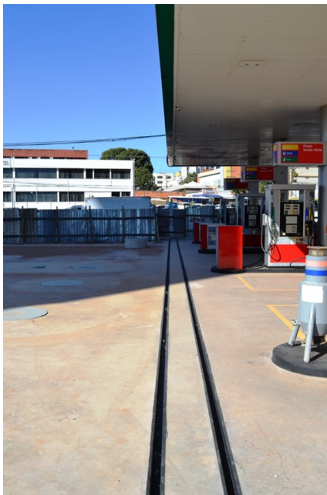
Figura 7 - Canaletes Internos do Sistema de Drenagem Oleosa - SDO e externas da drenagem de águas pluviais da pista de abastecimento com recuo interno de 0,5 metros conforme exige o item 4, da ABNT NBR 14.605-2:2010
