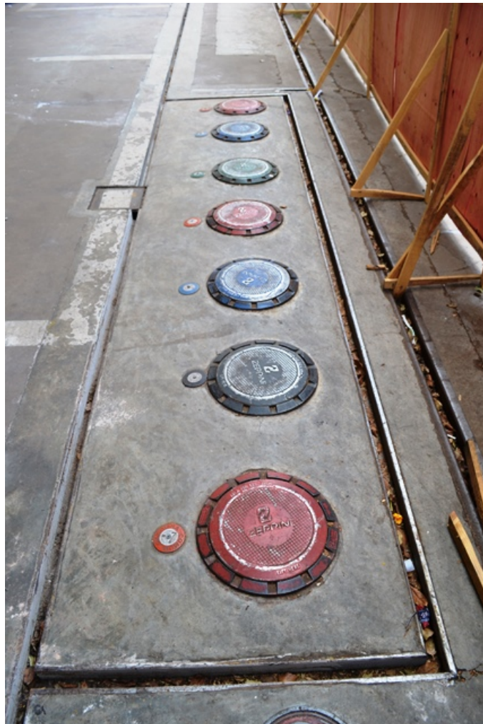
Figura 12 - Descarga selada à Distância. Observa-se que o dispositivo é circundado por caneletas direcionadas ao SAO exclusivo da pista de abastecimento e necessita de manutenção operacional constante.
