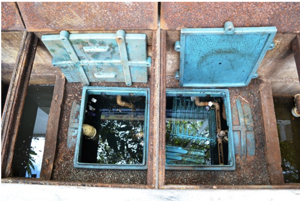
Figura 9 - Aspecto de um dos compartimentos da Caixa Separadora de Água e Óleo - CSAO do SAO da pista de abastecimento. O sistema instalado se encontra fora de operação e quando entrar em operação deverá realizar manutenção operacional semanal conforme exige a tabela 1 da ABNT NBR 15594-3:2008.
