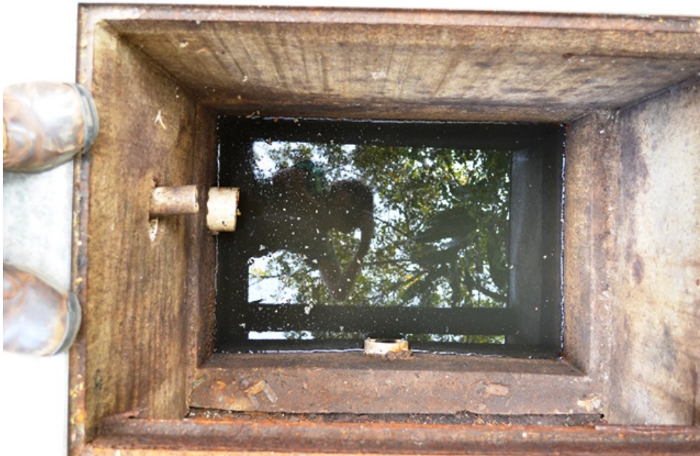
Figura 8 - Aspecto da Caixa de Areia.
