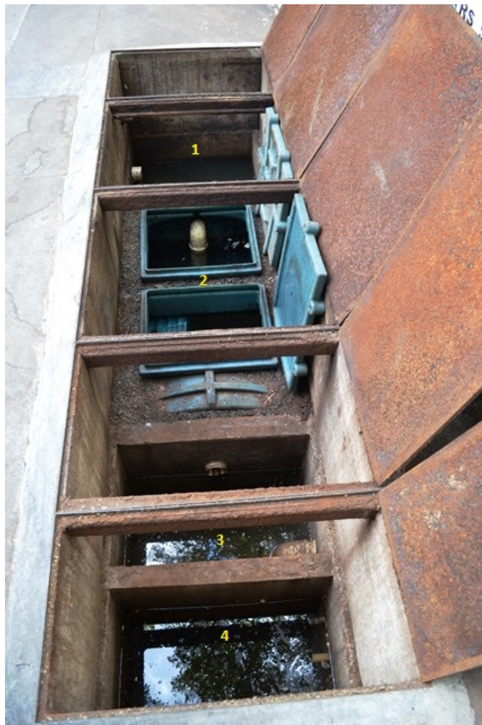
Figura 8 - Aspecto geral do SAO da pista de abastecimento. Observa-se que o Sistema possui (1) Caixa de areia, (2) Caixa separadora de água e óleo, (3) caixa de amostragem de efluentes e (4) caixa coletora de óleo.
