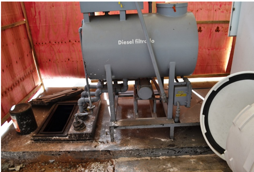
Figura 6 - Aspecto do filtro de Diesel fora de operação com sump .
