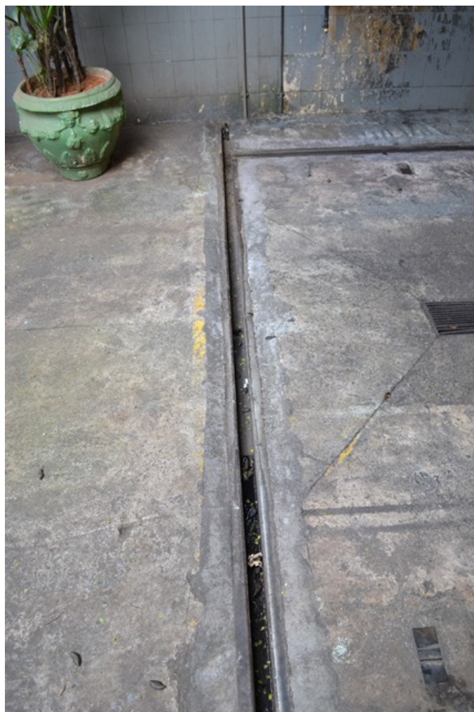
Figura 17 - Aspecto dos Canaletes da área de Lavagem de Veículos. Observa-se o acúmulo de resíduos na estrutura interna o que necessita de manutenção
