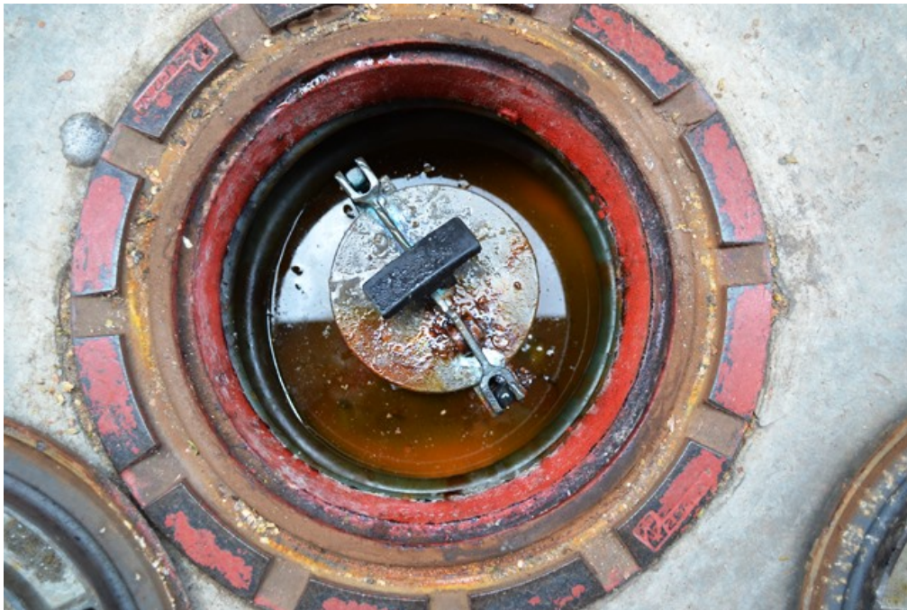
Figura 13 - Aspecto do interior da Descarga selada à Distância. Observa-se a cor do efluente no interior do dispositivo, denotando aparentemente ser combustível o que necessita de manutenção operacional constante conforme exige a tabela 1 da ABNT NBR 15594-3:2008.
