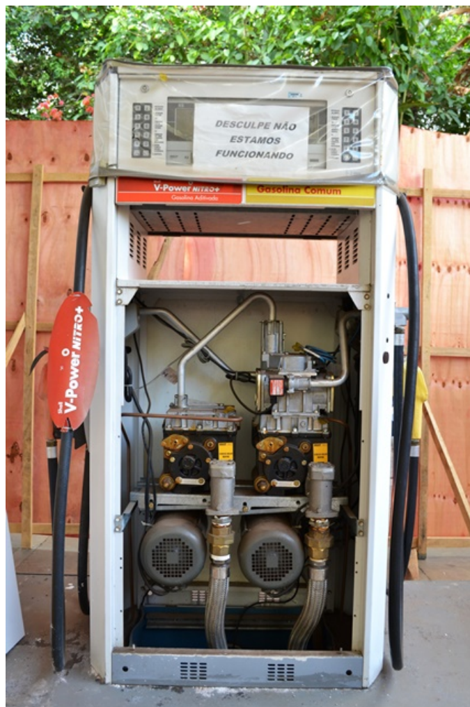
Figura 3 – Unidade abastecedora fora de operação de Gasolina Comum e Aditivada com o dispositivo de segurança check-valve.
