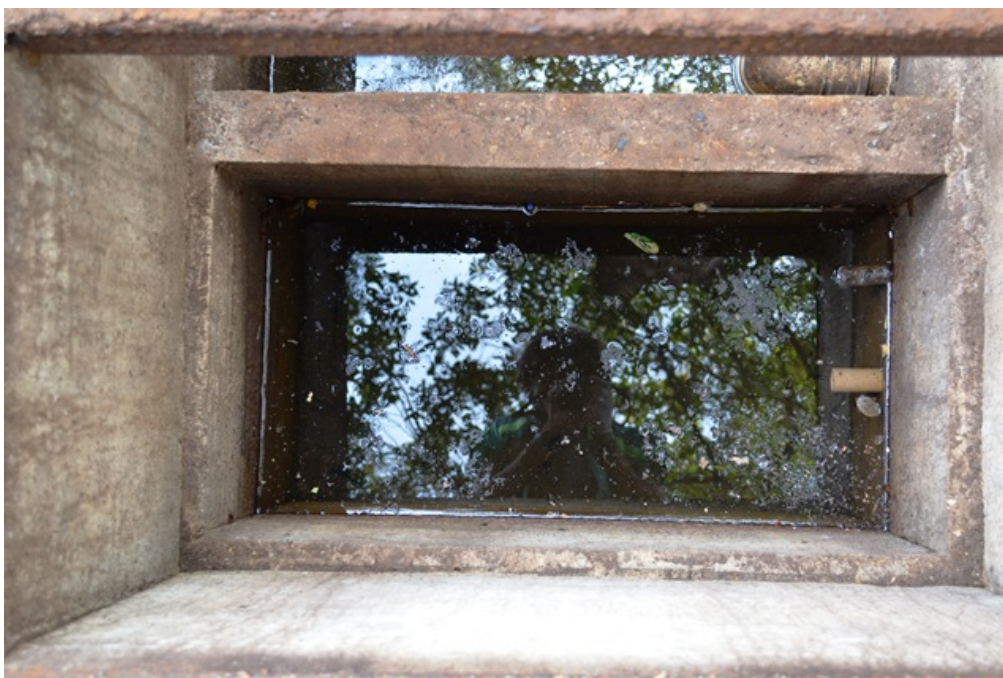
Figura 10 - Caixa coletora de óleo. Observa-se que a caixa está cheia de água da chuva em função da mesma está fora de operação.
