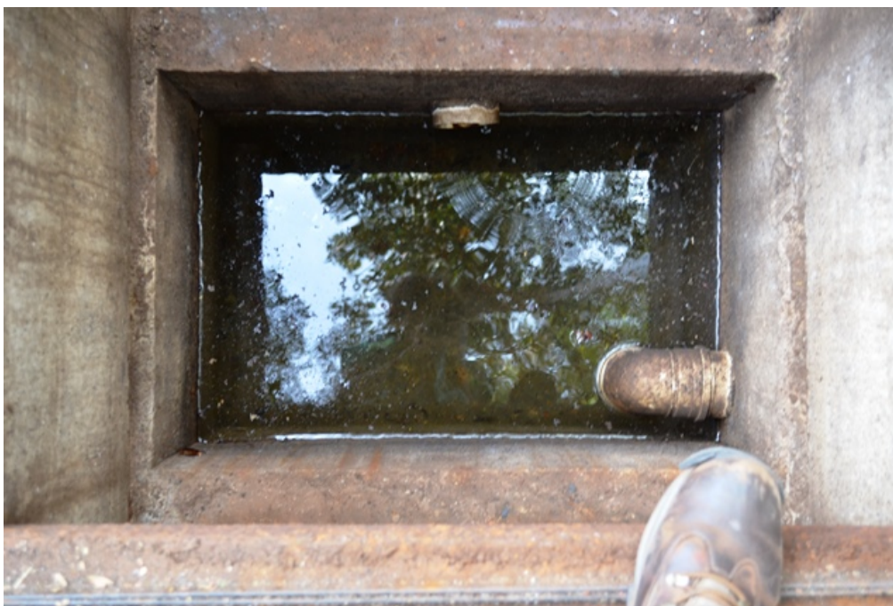
Figura 10 - Caixa de amostragem de efluentes, observa-se que os efluentes não possui a queda de 15 cm no qual é exigida na ABNT NBR 14.605-2:2010
