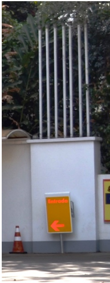
Figura 7 - Respiros com terminal corta chamas. Observa-se que dentro do raio esférico de 1,50 m ocorre a presença de indivíduos arbóreos em desacordo ao que é exigido na ABNT NBR 13783:2004.
