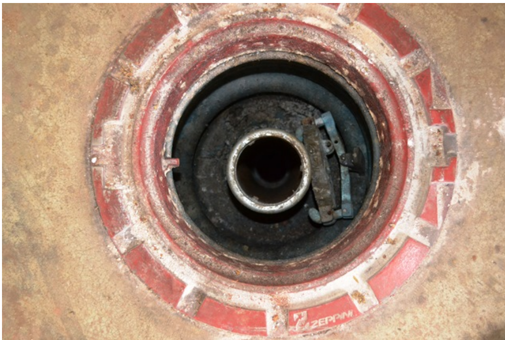
Figura 11 - Aspecto de um dos dispositivos ( Spill container ) da descarga selada sobre o tanque. Observa-se que a tubulação não está tamponada e o dispositivo necessita de manutenção operacional constante conforme exige a tabela 1 da ABNT NBR 15594-3:2008
