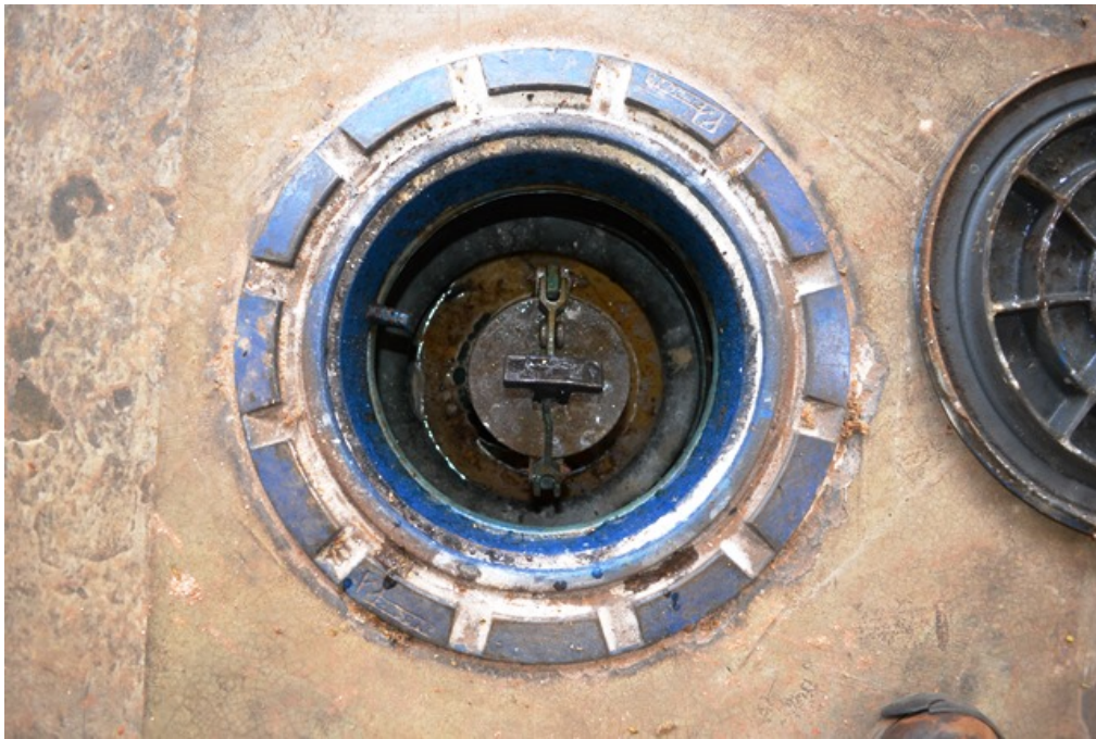
Figura 11 - Aspecto de um dos dispositivos da descarga selada sobre o tanque. Observa-se que o interior do dispositivo necessita de manutenção operacional constante conforme exige a tabela 1 da ABNT NBR 15594-3:2008
