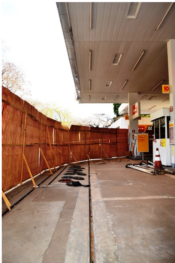
Figura 6 - Canaletas com recuo interno de 0,5 metros conforme exige o item 4, da ABNT NBR 14.6052:2010.
