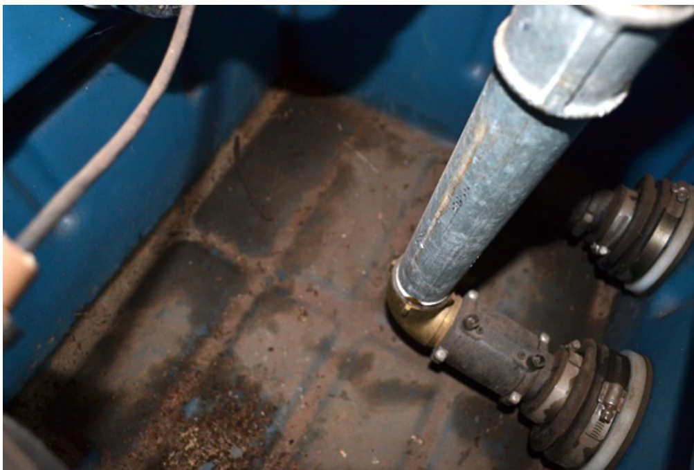
Figura 5 - Detalhe do interior da unidade abastecedora com a câmara de contenção de uma das Unidades Abastecedoras do SASC. A tubulação é do tipo não metálica conforme exige a ABNT NBR 14722, a mesma está totalmente contida no dispositivo de segurança e necessita de manutenção operacional diária conforme exige a tabela 1 da ABNT NBR 15594-3:2008.
