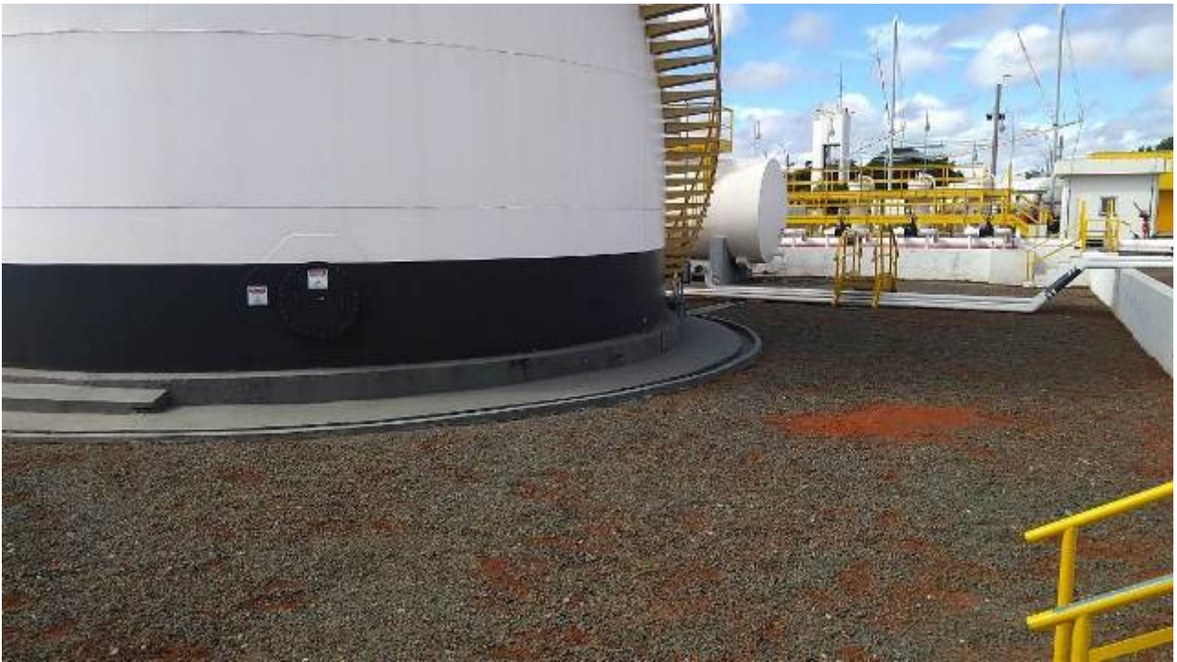
Foto 4 – Bacia de contenção contra vazamentos. Há 5 tanques no interior desta bacia.
