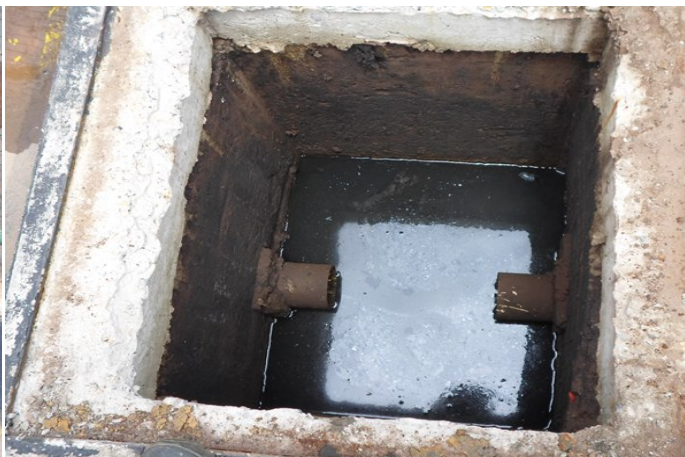
Foto 20: Caixa de amostragem fora das normas ABNT/NBR 14.605-21.
