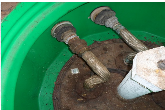
Foto 3: Estado do lacre e da bacia de contenção do tanque.
