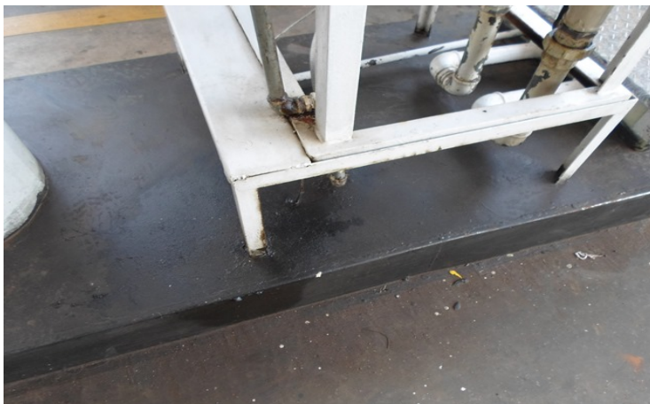
Foto 12: Unidade de diesel com indícios de vazamento.
