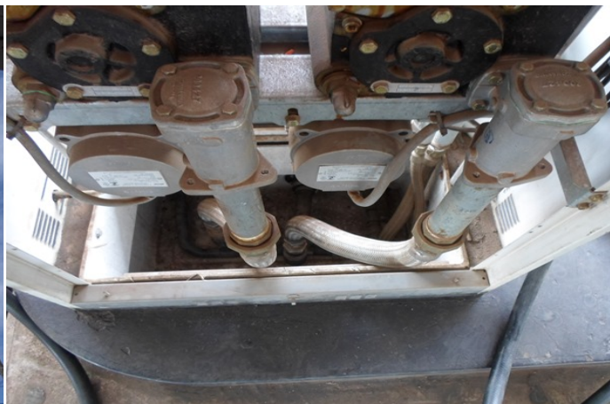
Foto 11: Detalhe do sump da unidade de abastecimento sem o tamanho adequado.
