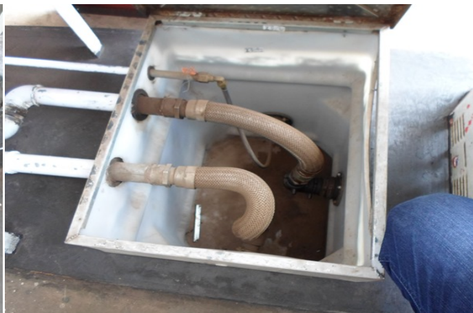
Foto 13: Unidade de filtragem de diesel.
