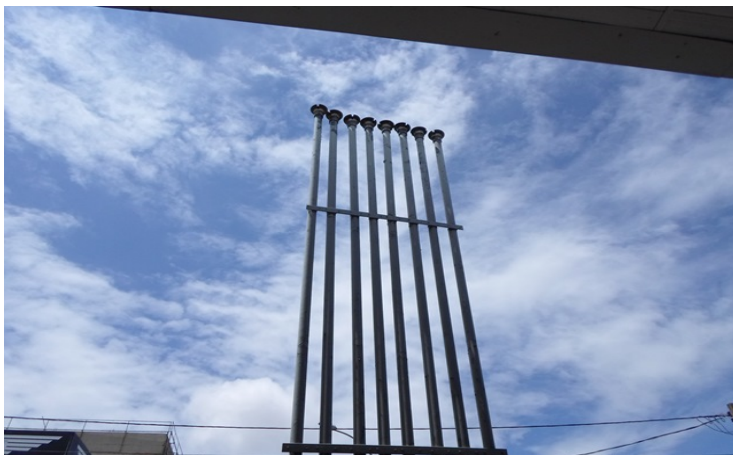
Foto 10: Respirios dos tanques.
