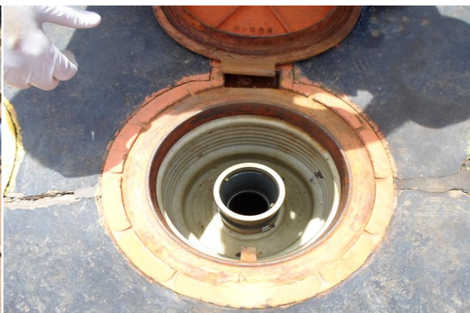
Foto 9: Detalhe da descarga selada à distância com manutenção adequada.
