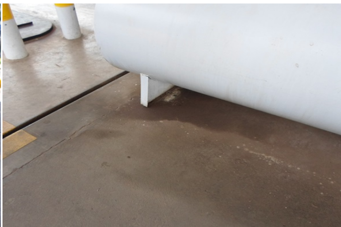
Foto 16: Detalhe da pista com rachadura e indício de manutenção inadequada.
