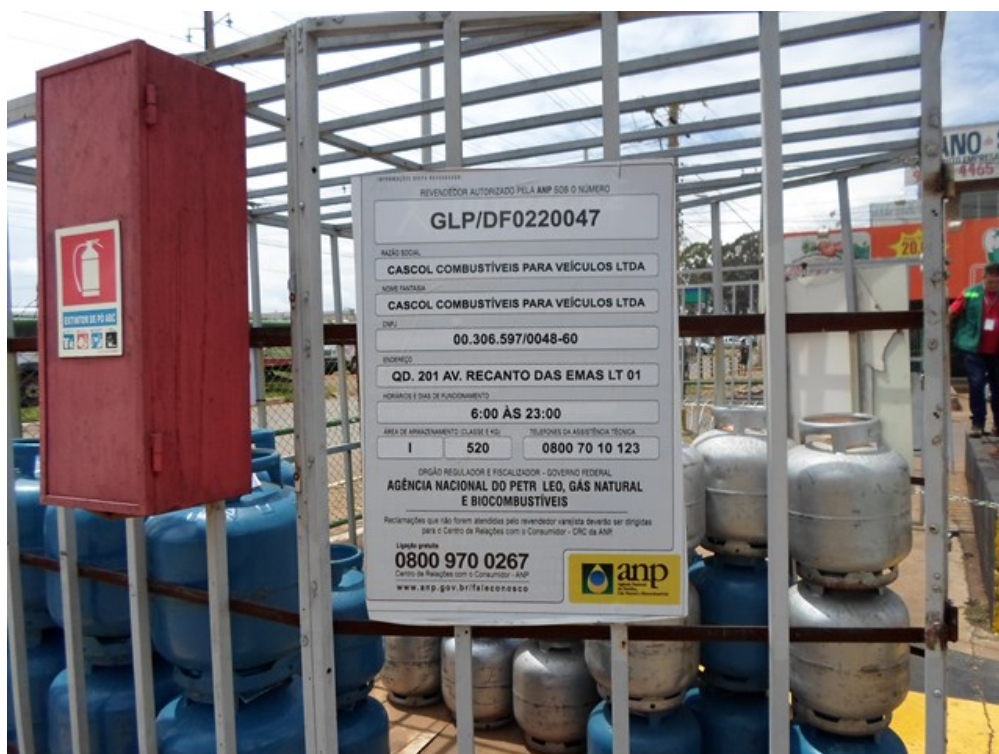
Foto 14: Local de armazenamento do GLP.
