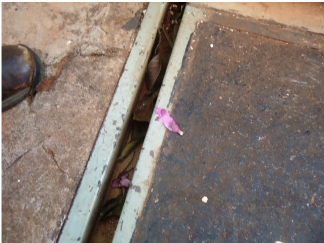
Foto 4 - Canaletas da área da pista de abastecimento com acúmulo de resíduos em sua estrutura interna.
