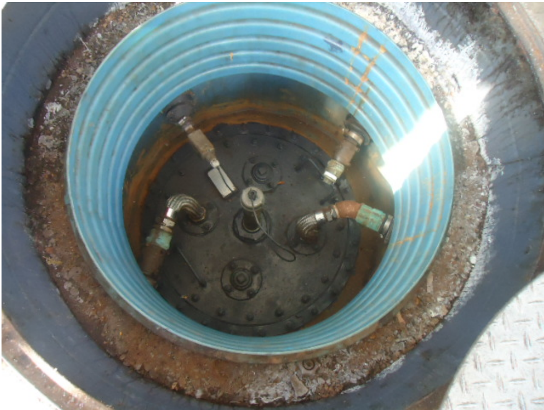
Foto 21 – Boca de visita de um dos 6 (seis) conjuntos de tanque de parede simples do Sistema de Armazenamento Subterrâneo de Combustíveis - SASC.
