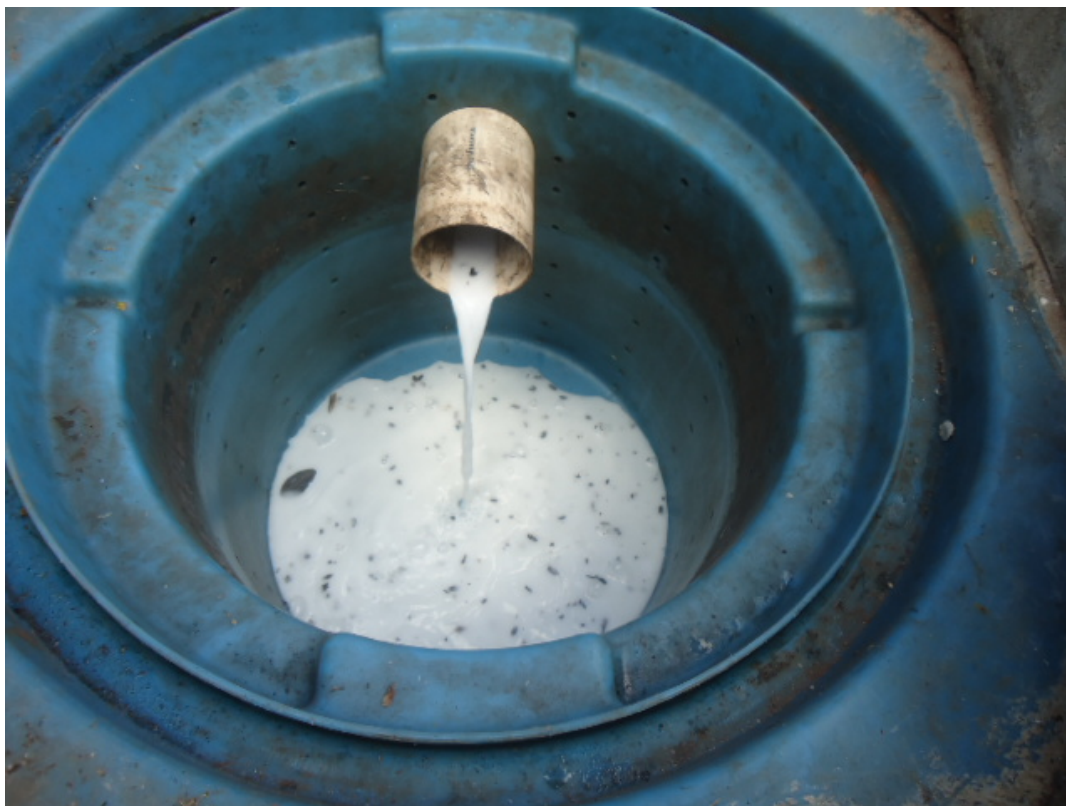
Foto 11 – Caixa de areia do Sistema Separador de Água e Óleo da pista de abastecimento. Observa-se que o sistema esta em pleno funcionamento em função do teste que foi realizado com corante nas canaletas do sistema de drenagem oleosa - SDO da pista de abastecimento.
