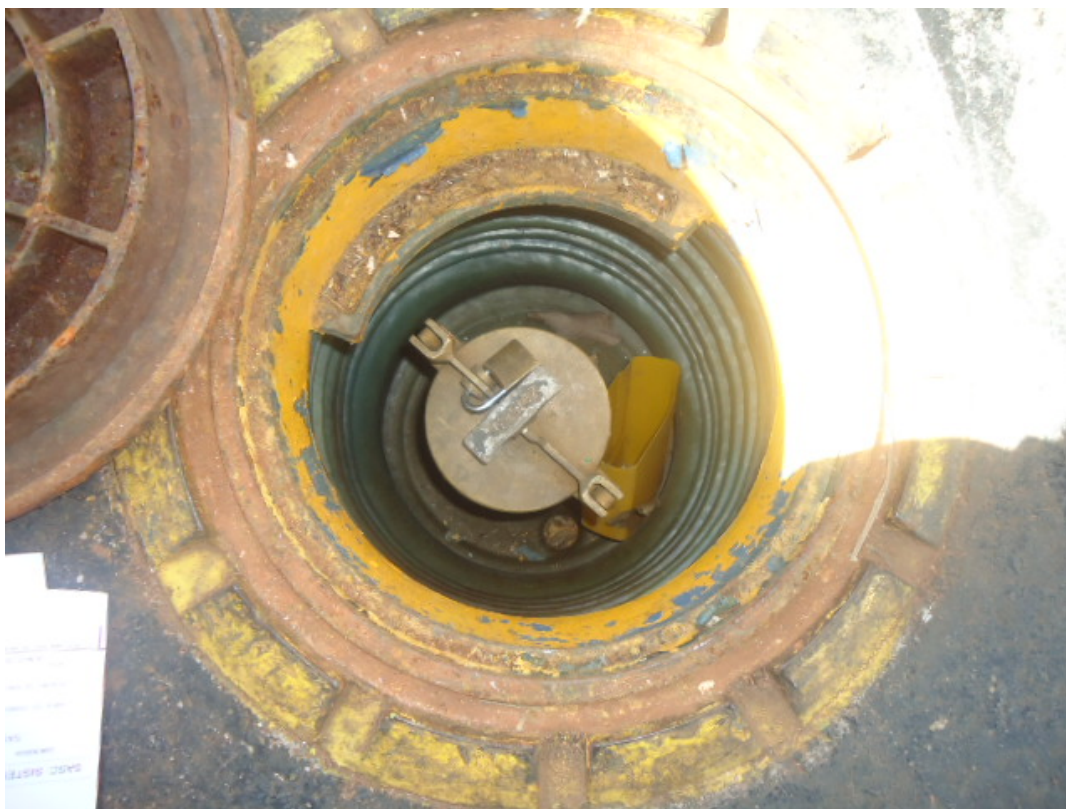
Foto 23 – Dispositivo de Descarga selada da Descarga selada à distância.
