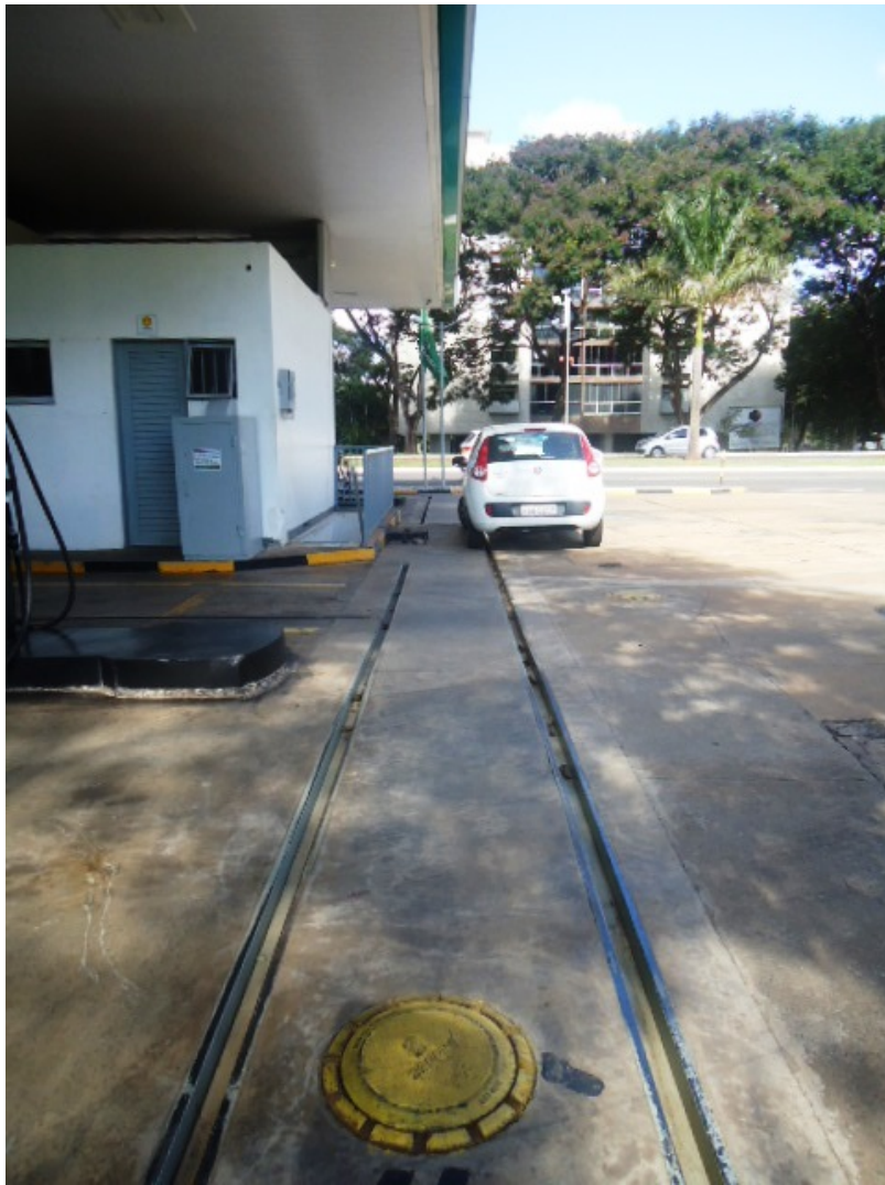
Foto 3 - Canaletas Internas do Sistema de Drenagem Oleosa - SDO e externas da drenagem de águas pluviais da área de abastecimento com recuo interno de 0,5 metros conforme exige o item 4, da ABNT NBR 14.605-2:2010.
