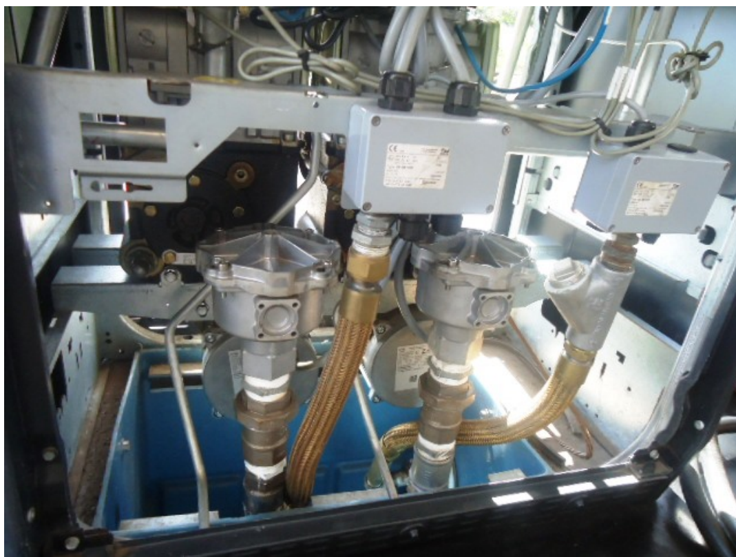
Foto 2 – Câmara de contenção junto a unidade abastecedora com check- valver .
