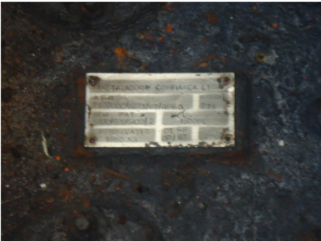
Foto 22 – Placa de identificação de um dos 6 (seis) conjuntos de tanque de parede simples do Sistema de Armazenamento Subterrâneo de Combustíveis - SASC.
