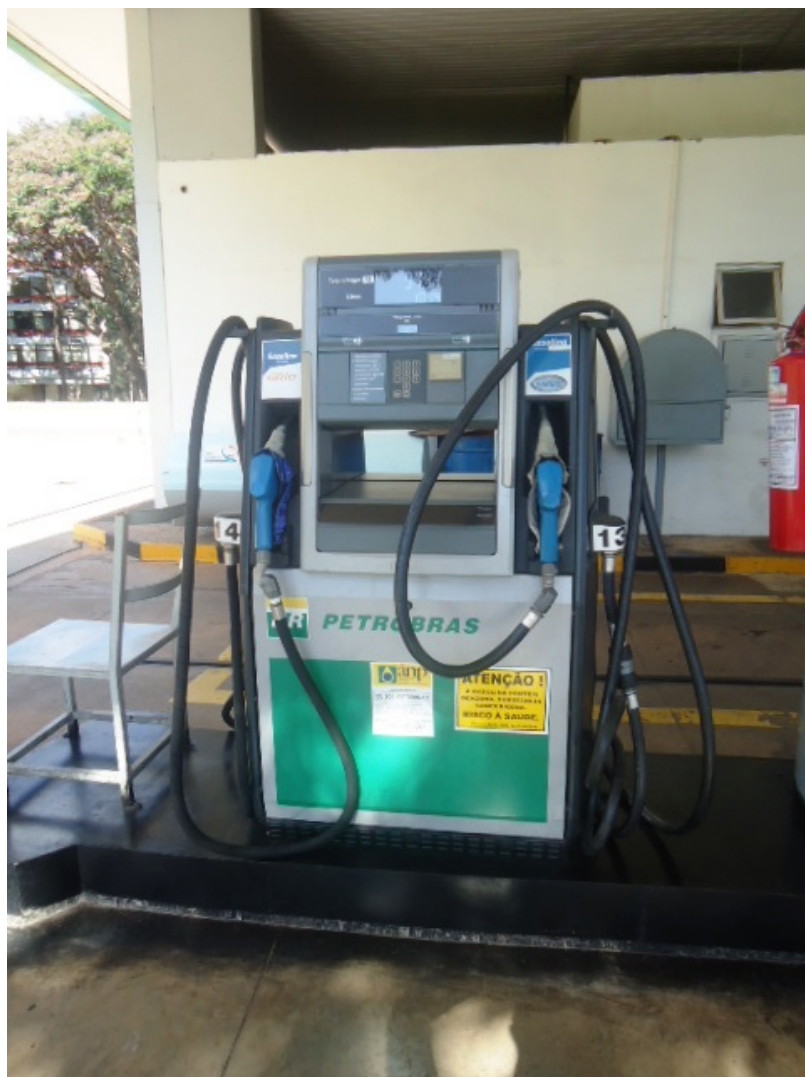
Foto 2 – Detalhe da Unidade Abastecedora de combustível.
