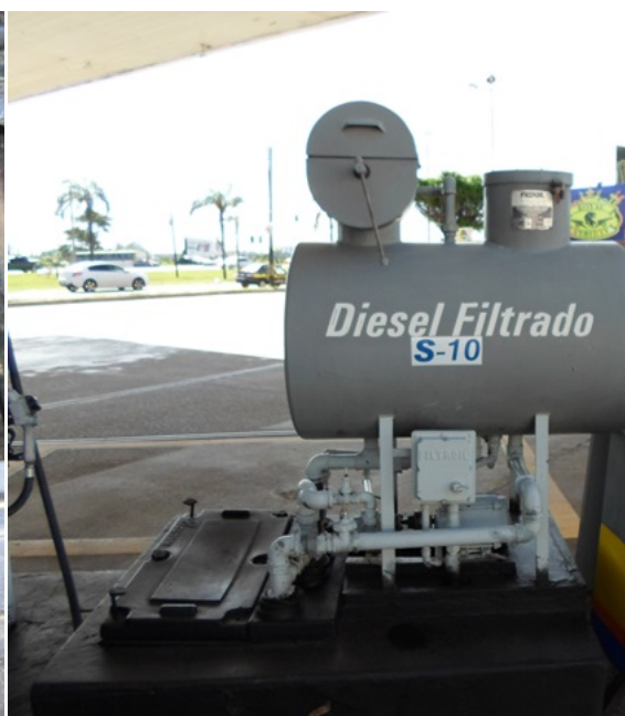
Foto 5 – Filtro de Diesel (S10) e câmara de contenção
