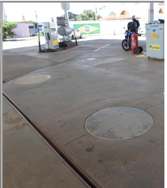
Foto 25 – Visão Geral do SASC.
