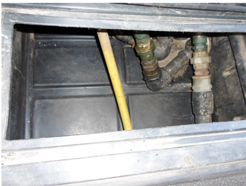
Foto 4 – Câmara de Contenção para Unidade de Filtragem, localizada na pista de abastecimento.
