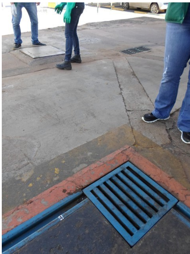
Foto 12 – Pista de abastecimento e canaletas com rachaduras e mal funcionamento.
