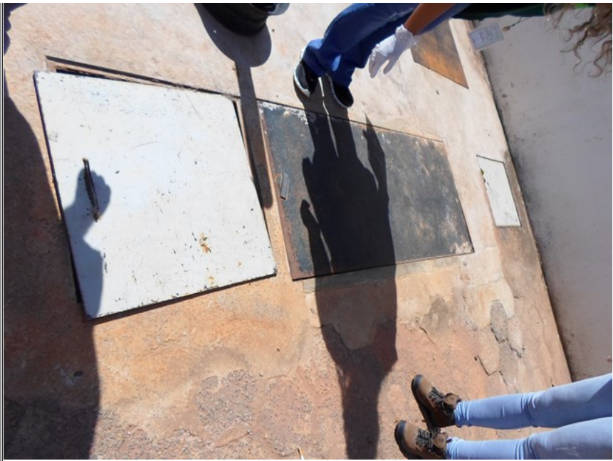
Foto 17 – Visão Geral do Sistema Separador de Água e Óleo (SAO) da pista de abastecimento.
