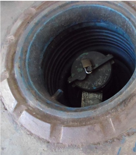
Foto 15 – Detalhe das descargas Seladas à
