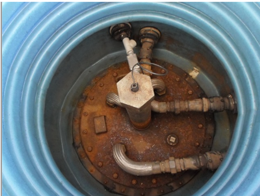
Foto 26 – Boca de Visita do Tanque evidenciando controle eletrônico de estoque e tubulação subterrânea de metal.
