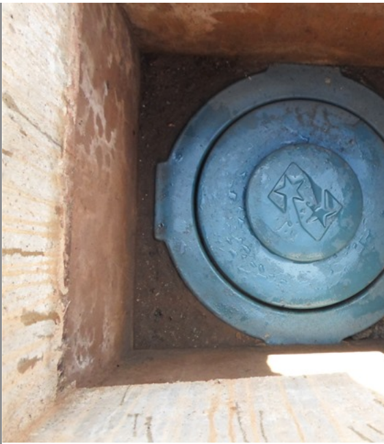
Foto 18 – Caixa Separadora do SAO da Pista de
