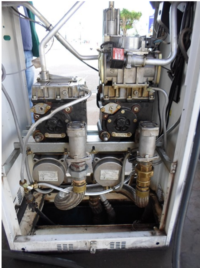
Foto 6 – Unidade abastecedora com sump e Check-valve.
