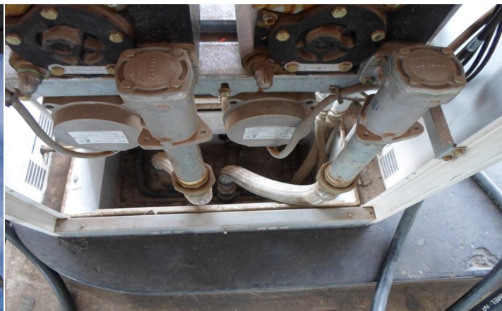
Foto 11: Detalhe do sump da unidade de abastecimento sem o tamanho adequado.
