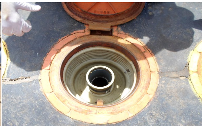
Foto 9: Detalhe da descarga selada à distância com manutenção adequada.
