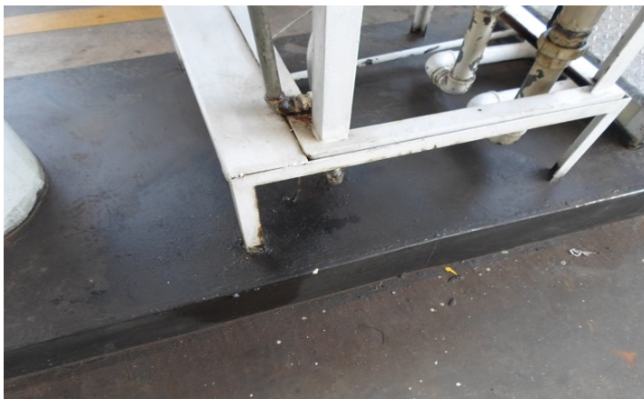
Foto 12: Unidade de diesel com indícios de vazamento.
