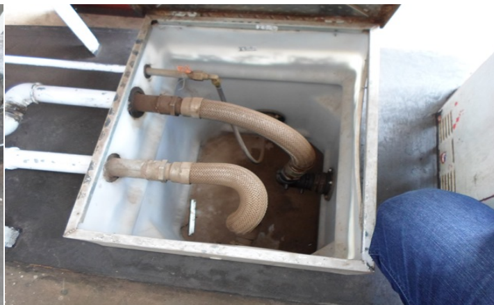
Foto 13: Unidade de filtragem de diesel.
