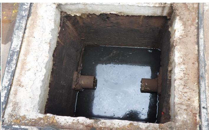
Foto 20: Caixa de amostragem fora das normas ABNT/NBR 14.605-21.
