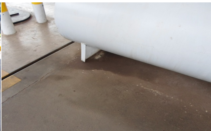
Foto 16: Detalhe da pista com rachadura e indício de manutenção inadequada.
