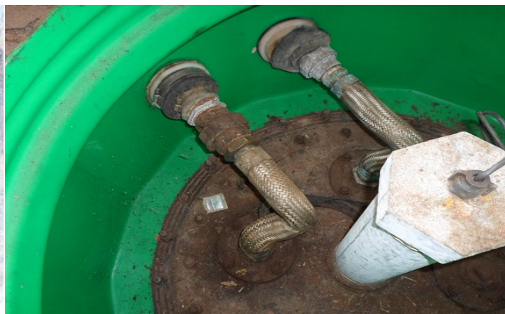
Foto 3: Estado do lacre e da bacia de contenção do tanque.
