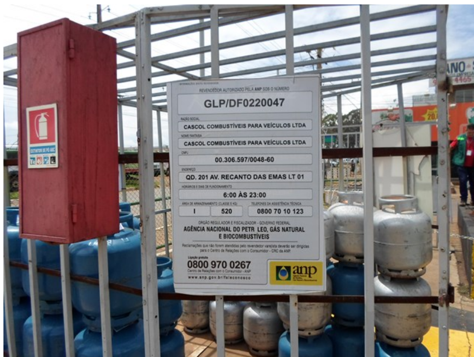
Foto 14: Local de armazenamento do GLP.
