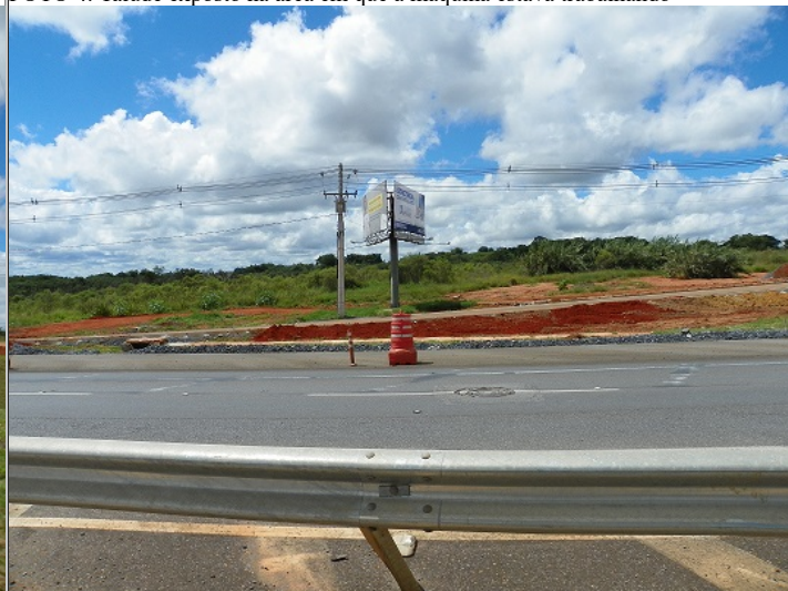
FOTO 4: Talude exposto na área em que a máquina estava trabalhando
