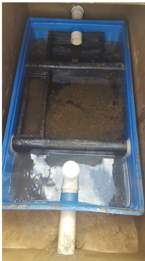
Foto 08 - S.A.O da pista de abastecimento, bacia de contenção e bomba
