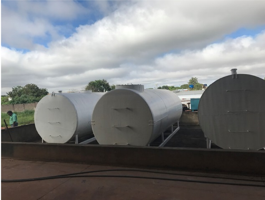
Foto 01 - Imagem dos tanques contidos da bacia de contenção
