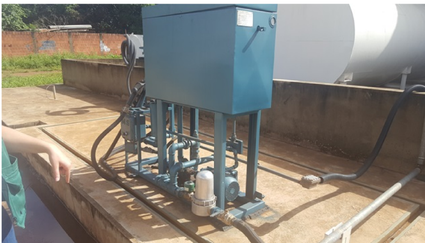
Foto 05 - Bomba de abastecimento sem câmara de contenção, dentro de canaletas e interligada a um dos tanques
