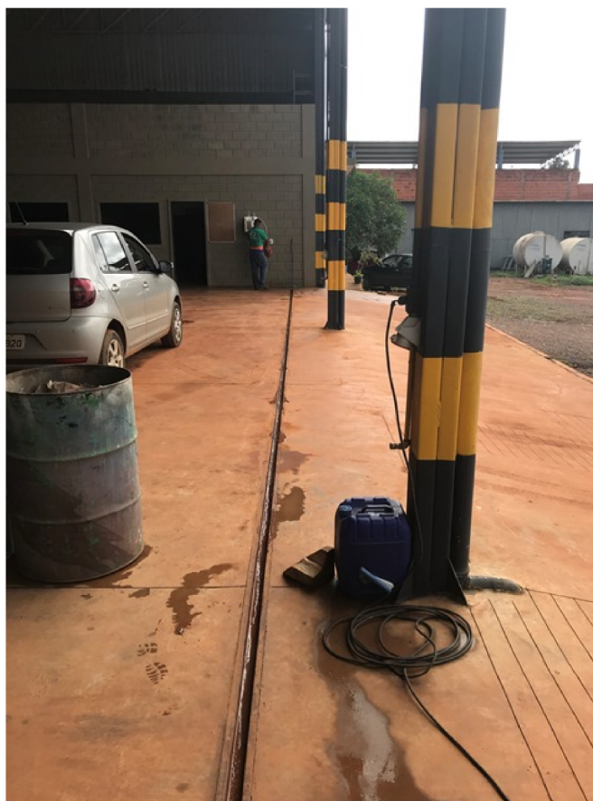
Foto 07 - Galpão no terreno do empreendimento, com canaletas onde foi verificado que estava sendo usado como estacionamento
