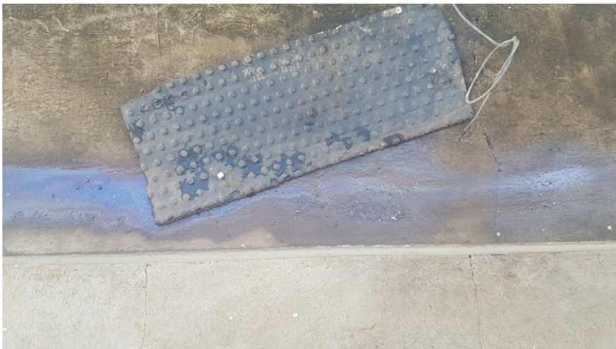
Foto 04 - Vestígios de combustível com água de chuva na bacia de contenção
