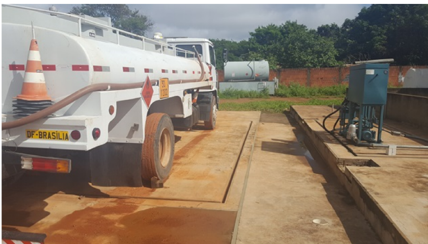
Foto 06 - Pista de abastecimento sem cobertura, circundado por canaletas
