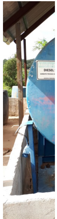
Foto 8 - Detalhe do tanque de combustível
