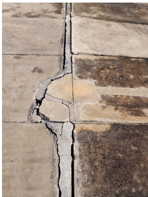
Foto 3: Dilatação das juntas.
