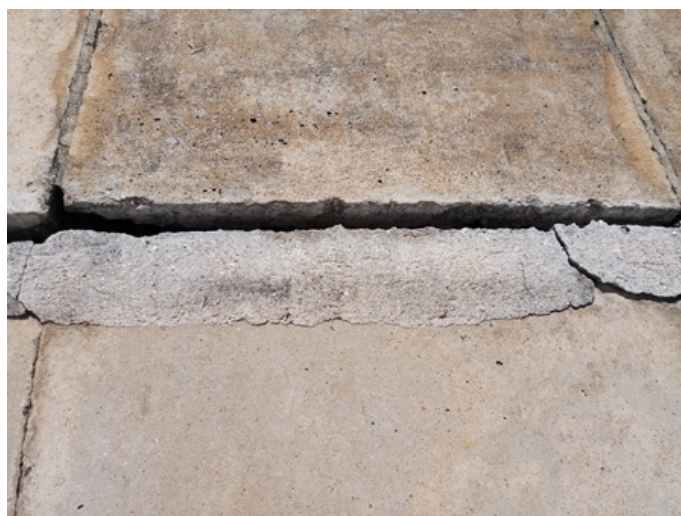
Foto 2: Dilatação das juntas.
