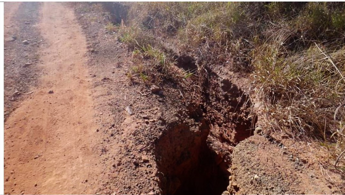
Figura 2 – Processo erosivo disposto na lateral da obra.
