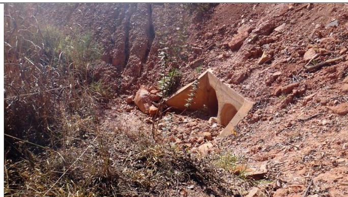
Figura 4 – Verifica-se direcionamento de sedimentos ao bueiro.
