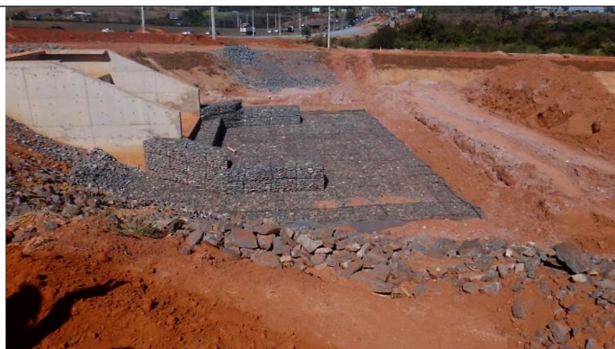
Figura 5 – Dissipador na entrada da bacia de qualidade.
