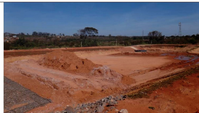
Figura 6 – Sedimentos acumulados no período chuvoso no interior da bacia de qualidade.
