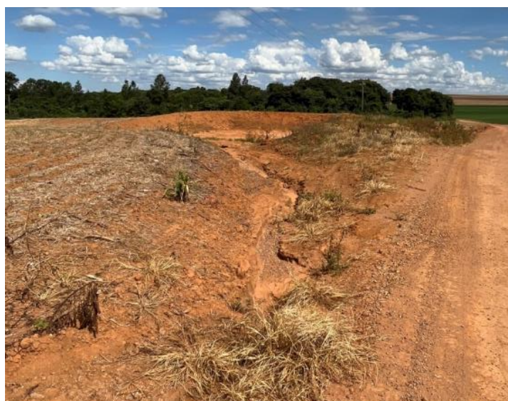
Figura 122: Bacia de contenção de água da chuva ao longo da estrada de chão. Fonte: Maria Rita Fonseca, 2023
