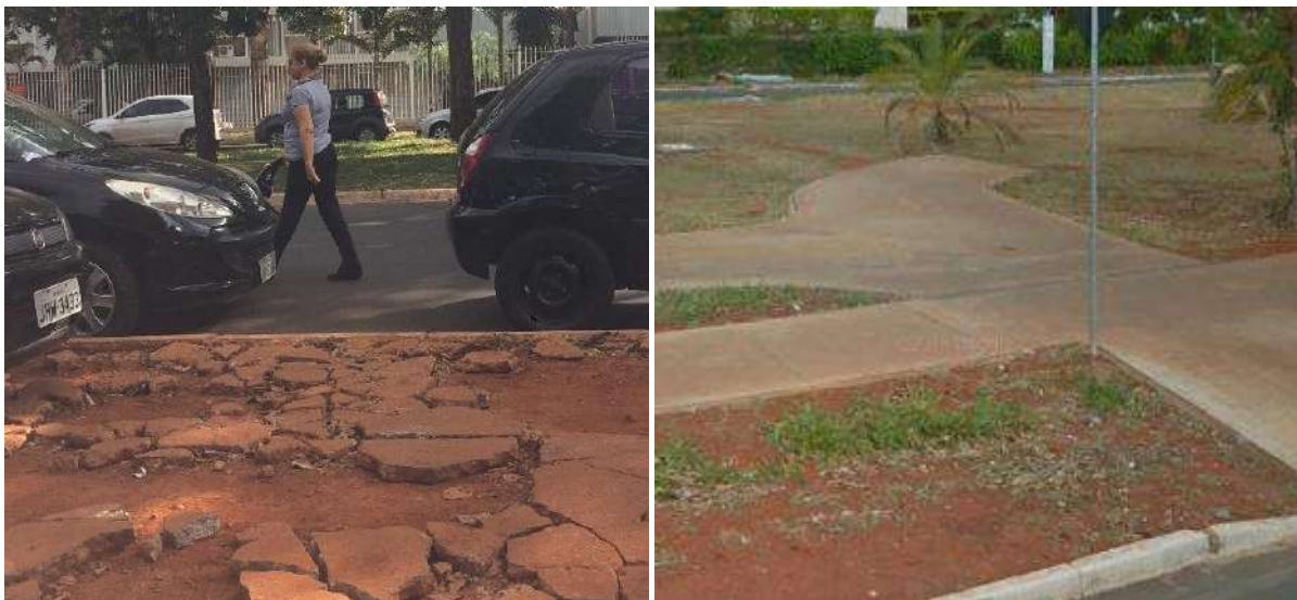
Figura 45. Esquerda: calçada em péssimo estado de conservação no SRTVS, Brasília. Direita: ciclovia interrompida, sem conexão, Sudoeste. Fonte: Esquerda: Gabriela Tenorio. Direita: Google StreetView.
