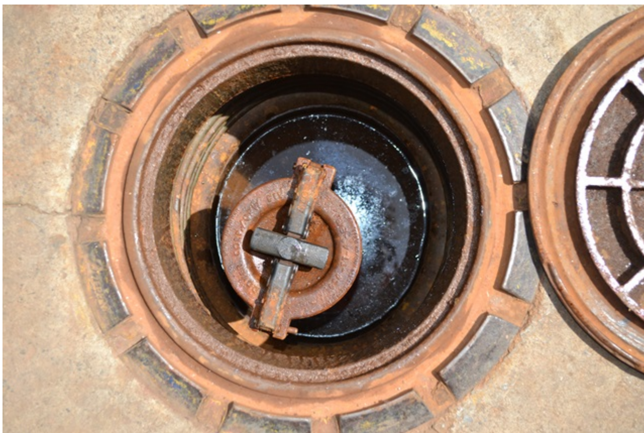
Figura 8: Detalhe de uma das descargas seladas à distância. Nota-se presença de líquido, comprovando a falta de manutenção adequada.
