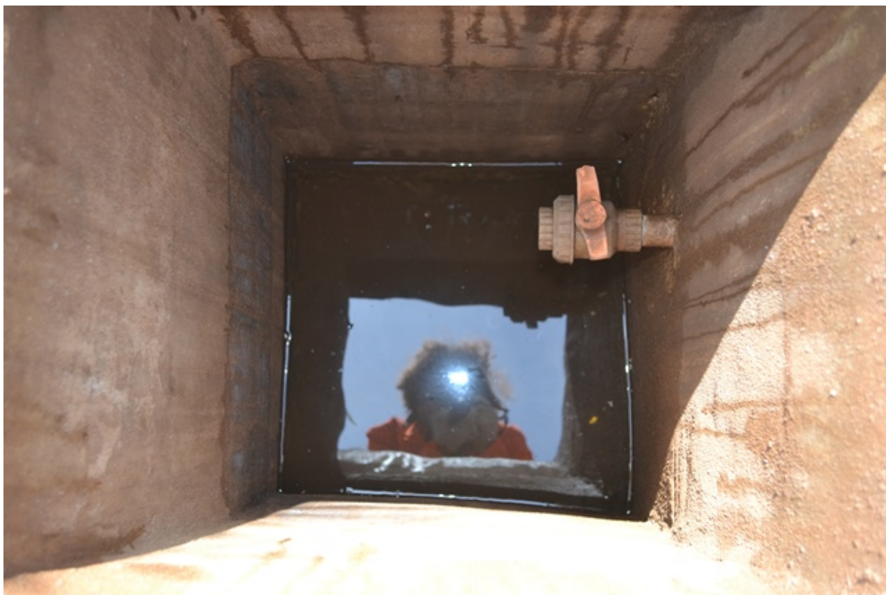
Figura 24: Caixa de coleta de óleo do do S.A.O. da pista, descarga à distância e lubrificação.
