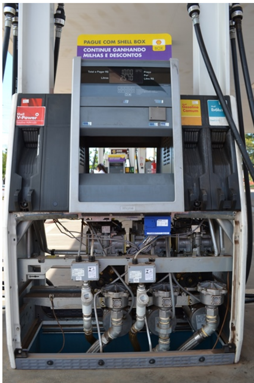
Figura 11: Unidade abastecedora apresentando 6 bicos injetores de combustível.
