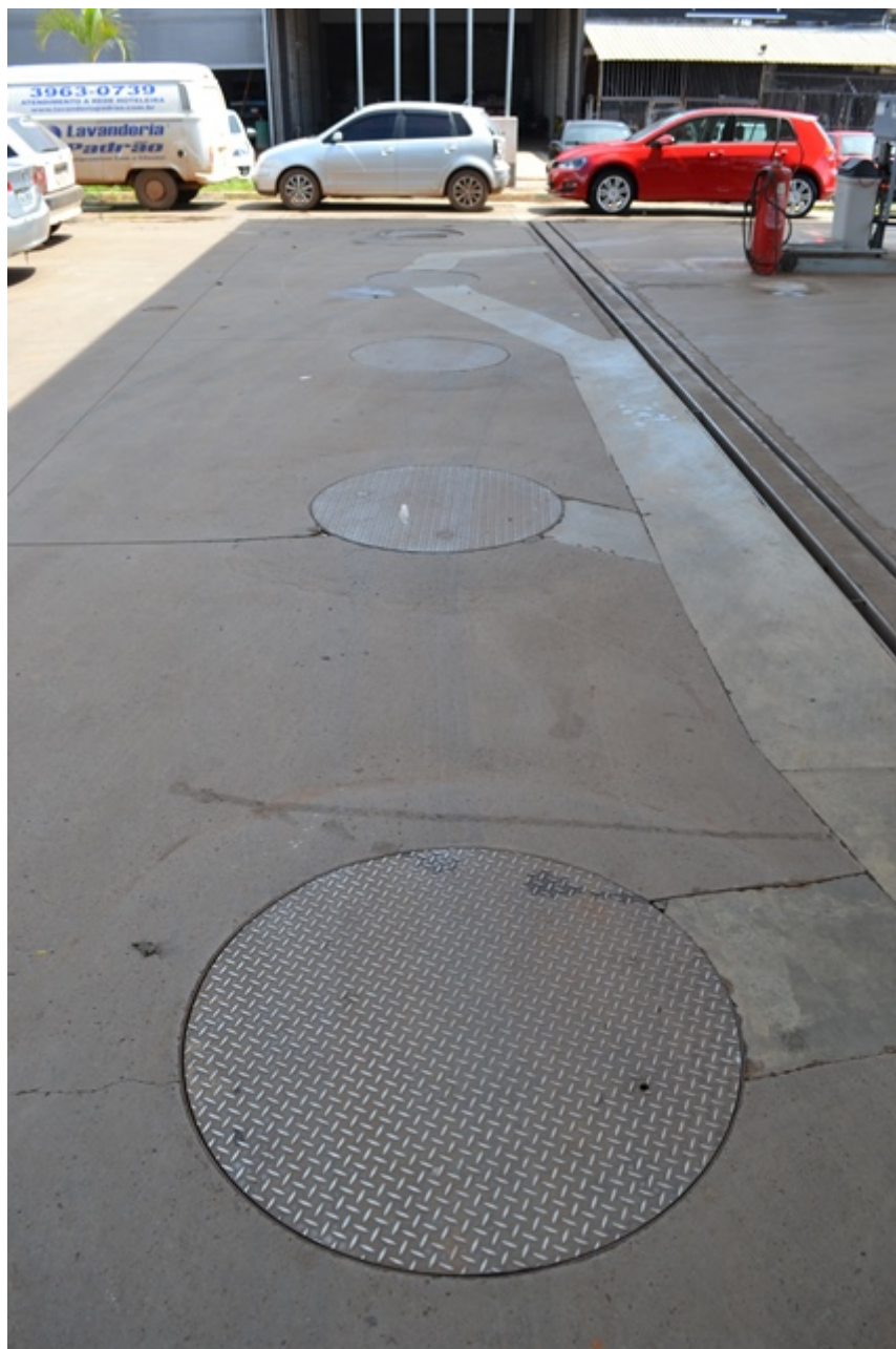
Figura 3: Área de tancagem com presença de cinco tanques plenos de parede simples.
