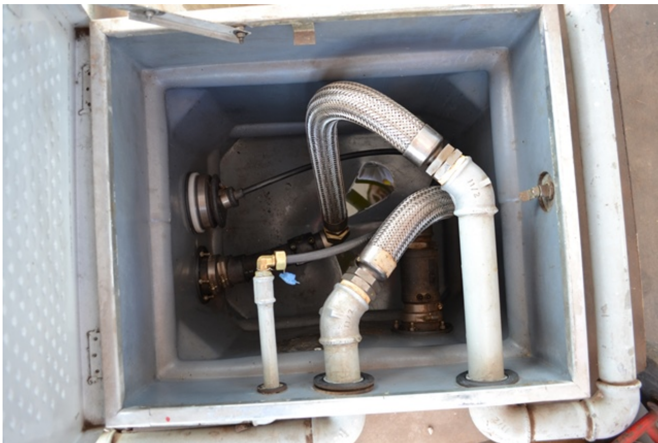
Figura 14: Câmara de contenção da unidade filtrante de diesel. Nota-se que as tubulações estão contempladas pelo sump .
