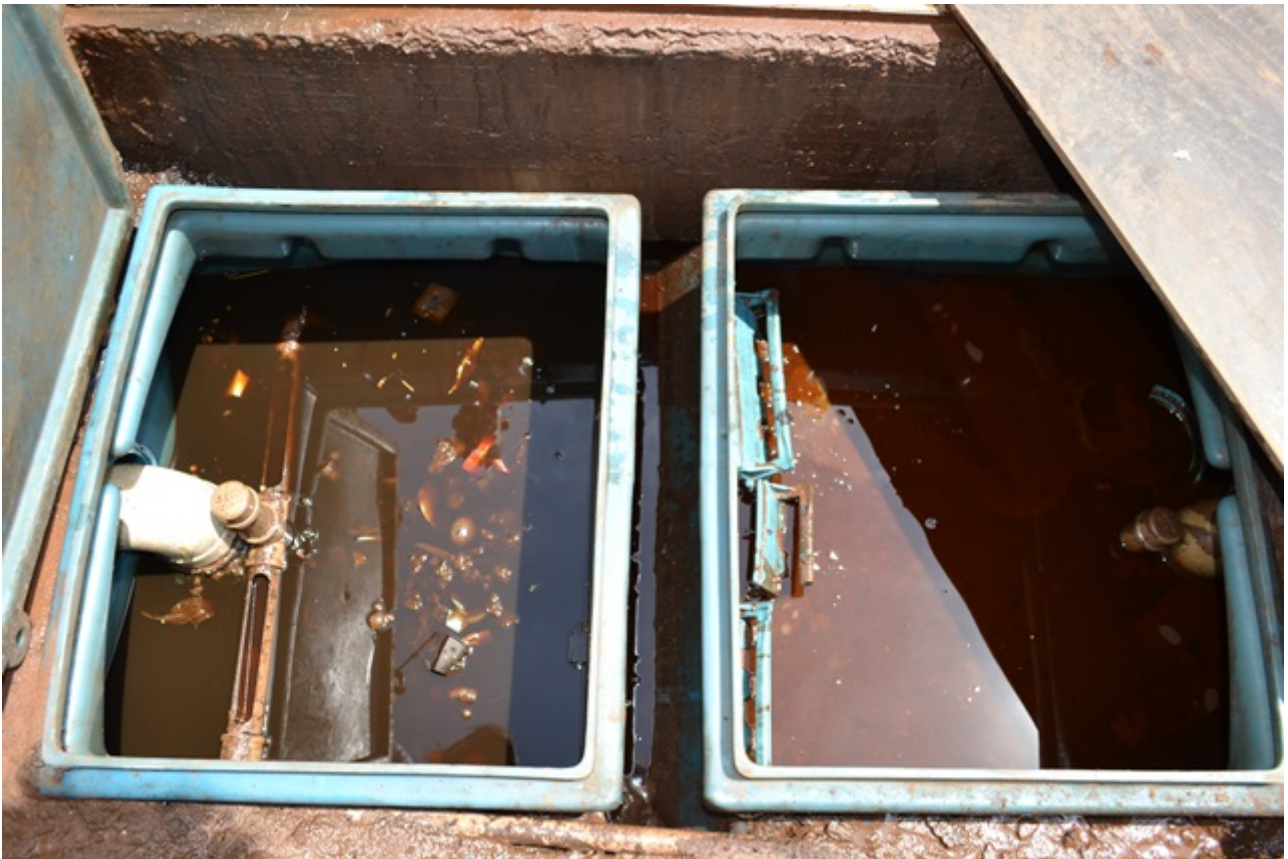
Figura 26: Caixa separadora de água e óleo do S.A.O. da área do lava-jato em péssima manutenção, comprometendo o funcionamento do Sistema.
