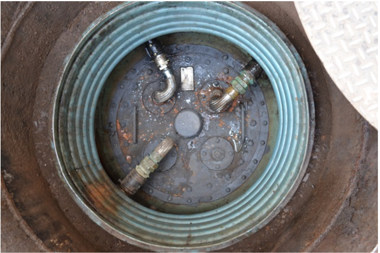
Figura 4: Boca de visita do tanque, nota-se a ausência de monitoramento intersticial e presença da placa de fabricação.
