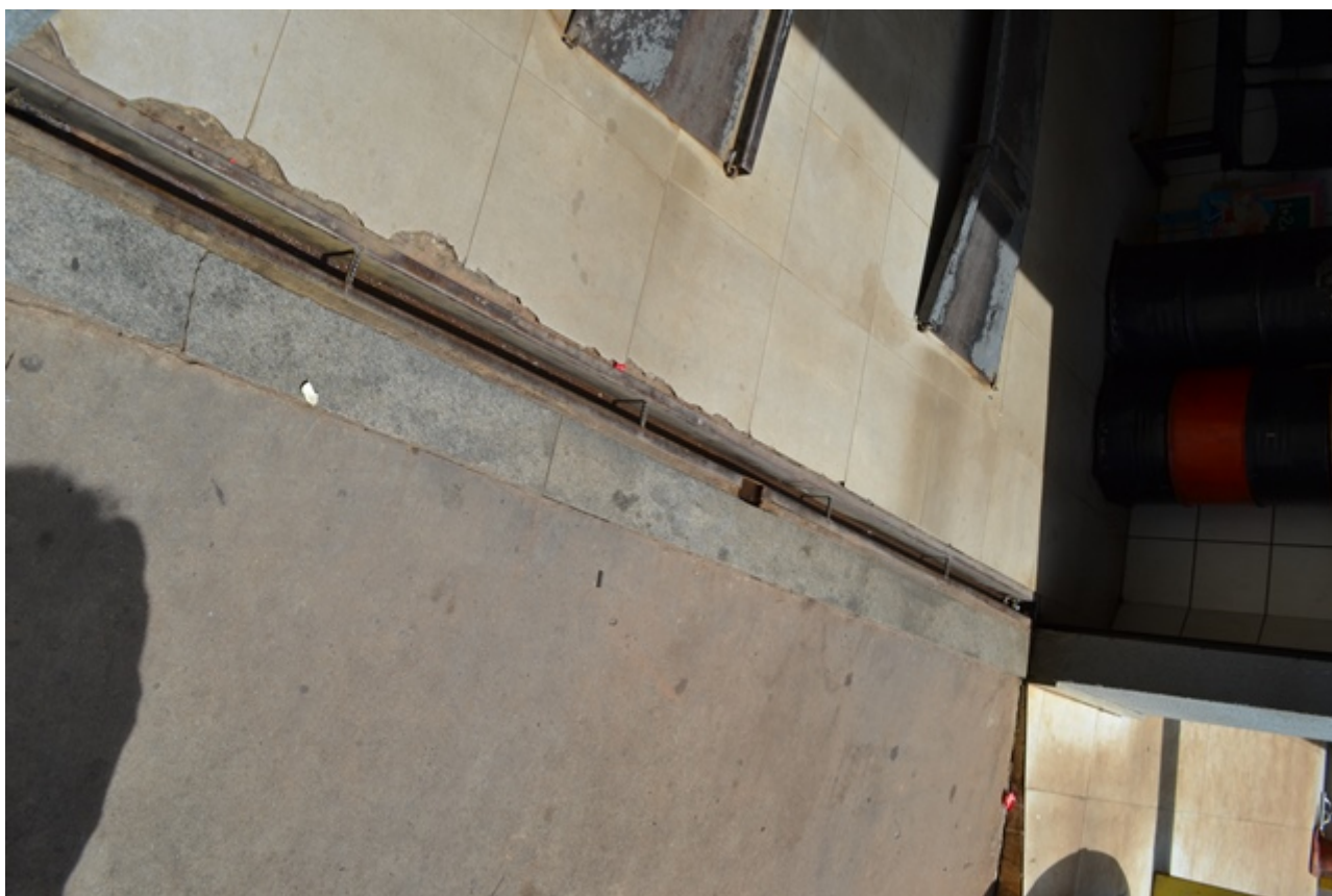
Figura 17: Entrada da área de lubrificação de veículos contemplada com canaletas direcionadas ao S.A.O. da pista de abastecimento.
