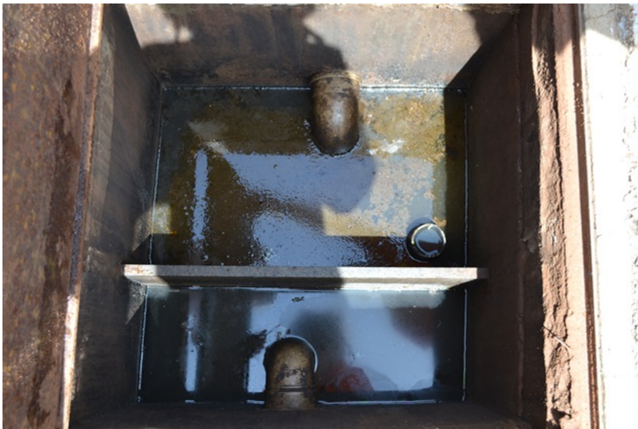
Figura 23: Caixa separadora de água e óleo do S.A.O. da pista, descarga à distância e lubrificação.
