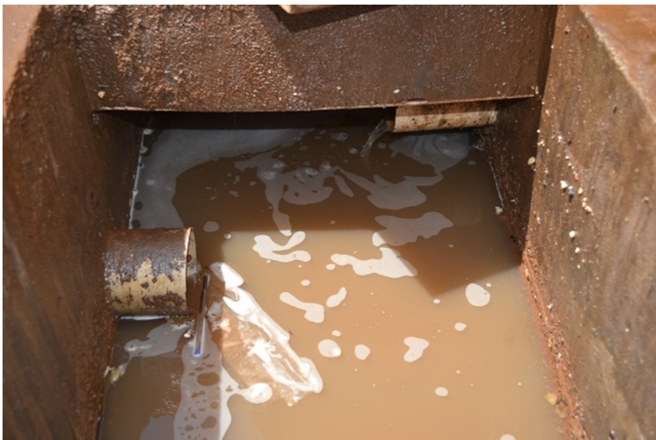
Figura 25: Caixa de areia do S.A.O. da área de lava-jato. Nota-se a falta de manutenção do sistema.
