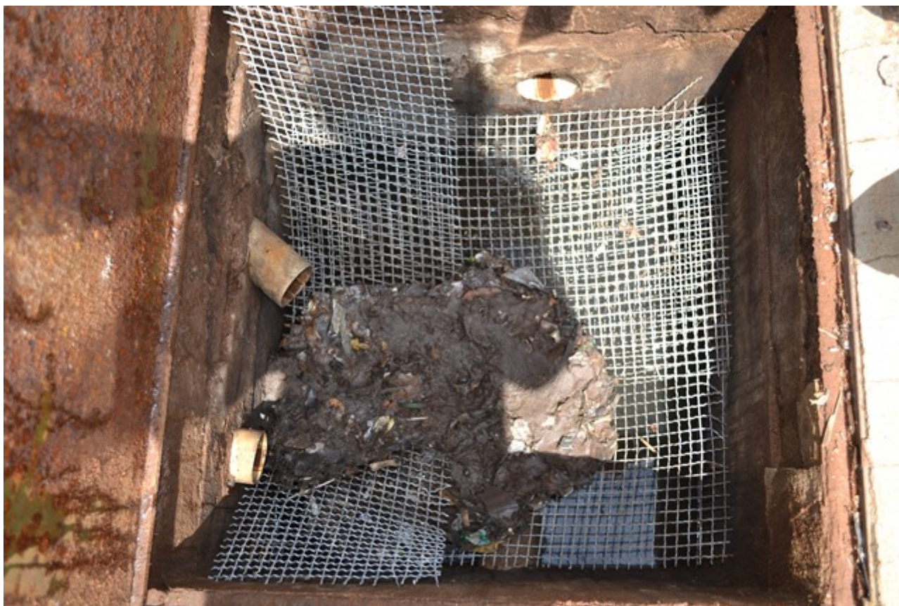
Figura 22: Caixa de areia do S.A.O. da pista, descarga à distância e lubrificação. Nota-se uma grade contendo resíduos sólidos, indicando a falta de manutenção dos canaletes.
