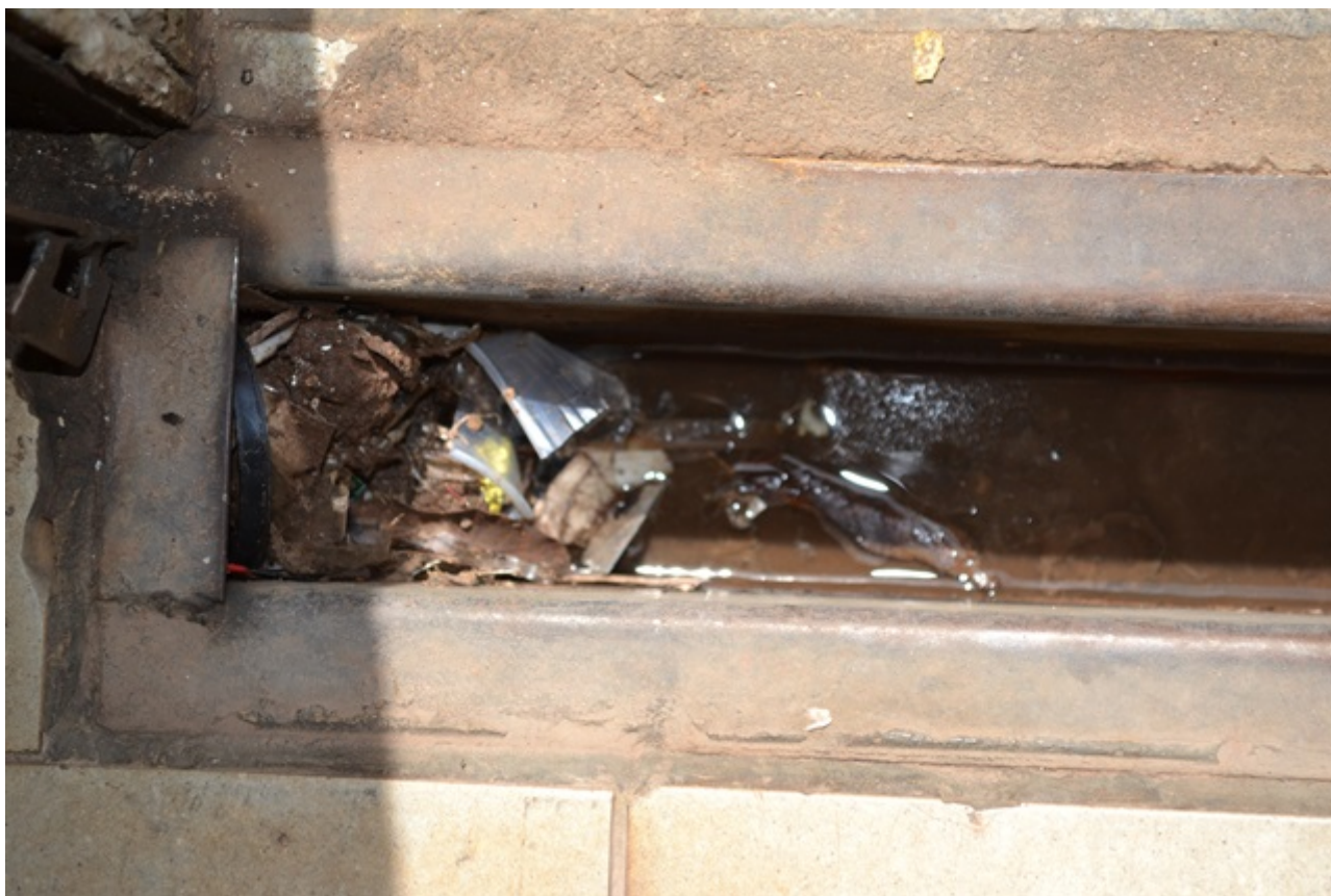
Figura 18: Detalhe dos canaletes sem manutenção adequada.
