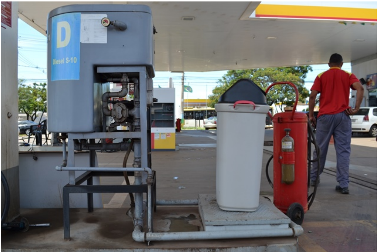
Figura 13: Unidade de filtro de diesel e câmara de contenção do filtro em boa manutenção.
