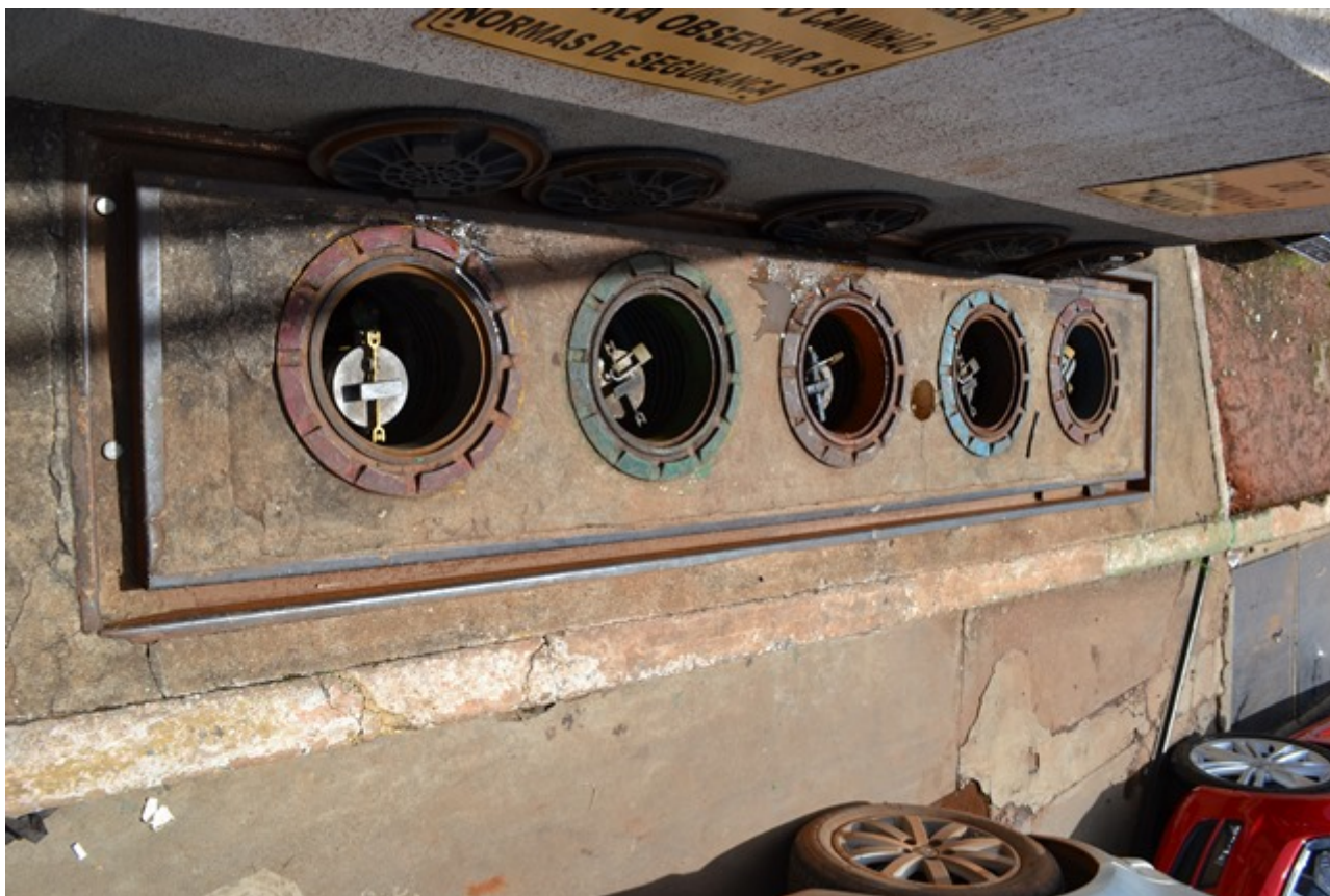
Figura 6: Descarga selada a distância contemplada por canaletes e com manutenção inadequada.
