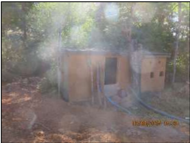
Foto 27: Estrutura construída para abrigar as bombas que captam água no leito do córrego Paranoazinho.
