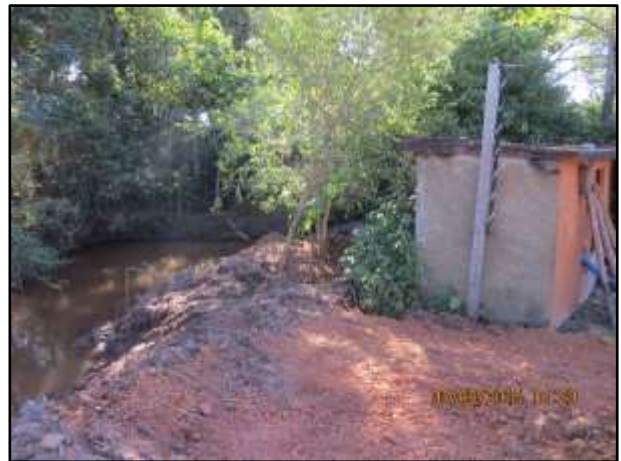
Foto 28: Perfil do leito do córrego Paranoazinho e a edificação que abriga as bombas.
