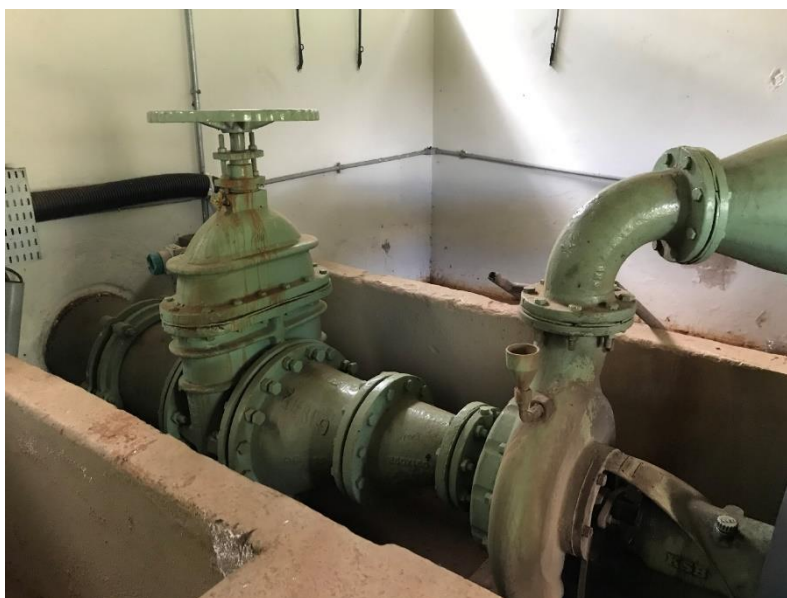
Figura 9 - EEAB – Instalação Hidromecânica
