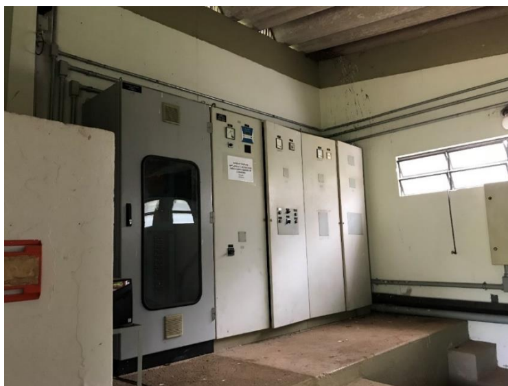
Figura 10 - EEAB – Energização e automação
