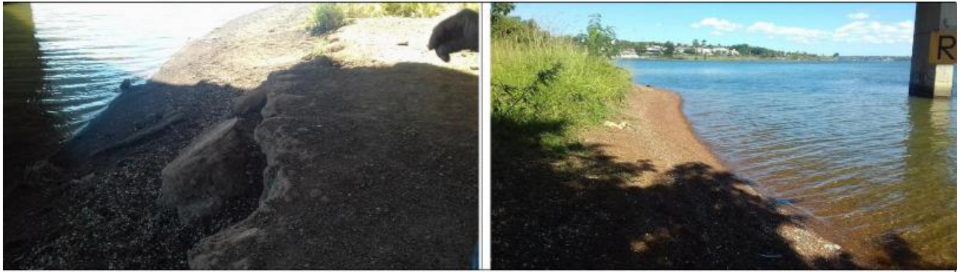
Figuras 7 e 8 – Trechos com deslizamento de material terroso na margem do Lago Paranoá.
