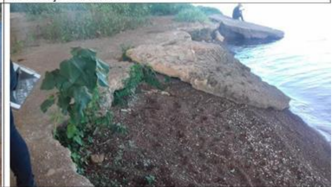
Figura 7 – Deslizamento de material terroso na margem do Lago Paranoá.
