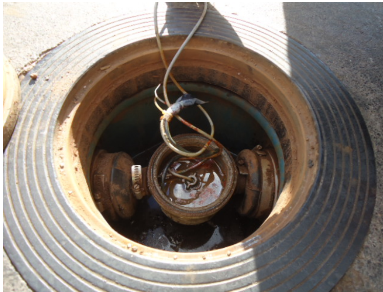
Foto 5. Monitoramento intersticial de um dos tanques está em mal estado de conservação.
