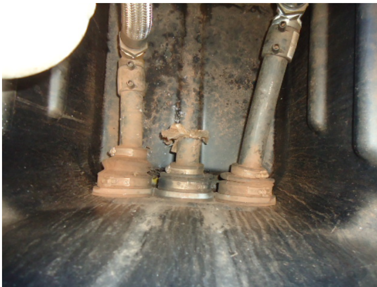
Foto 4. Tubulações do filtro de diesel com cano quebrado.
