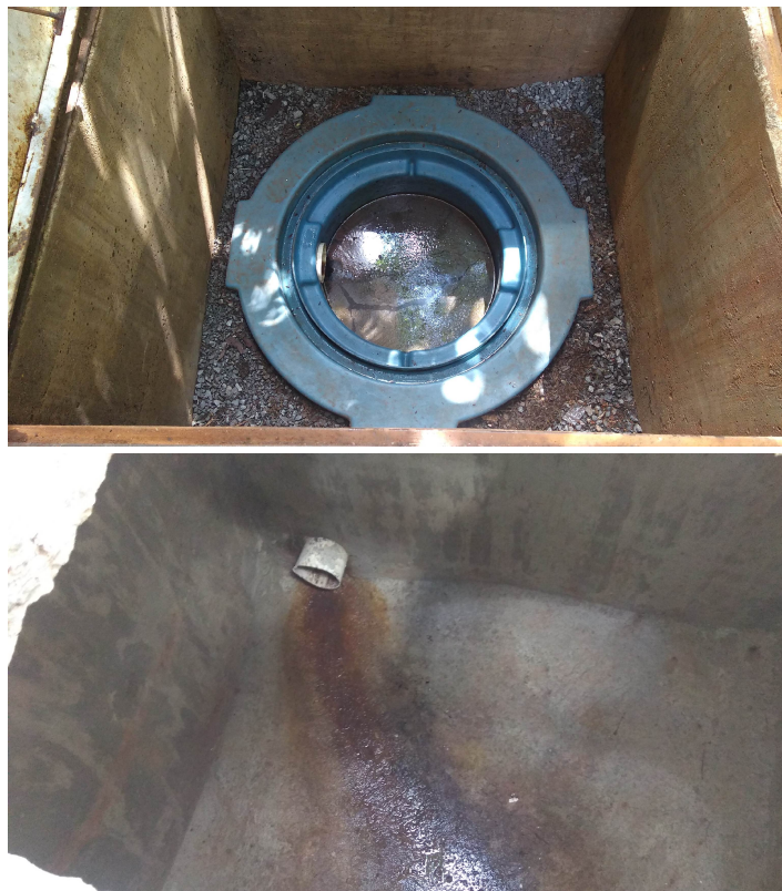
Figura 15 - Caixa de areia (esquerda) e Caixa de amostragem (direita)
