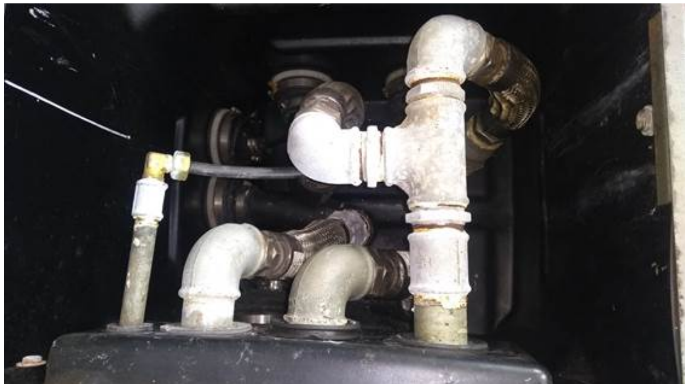
Figura 10 - Câmara de contenção da unidade de filtragem de óleo diesel.
