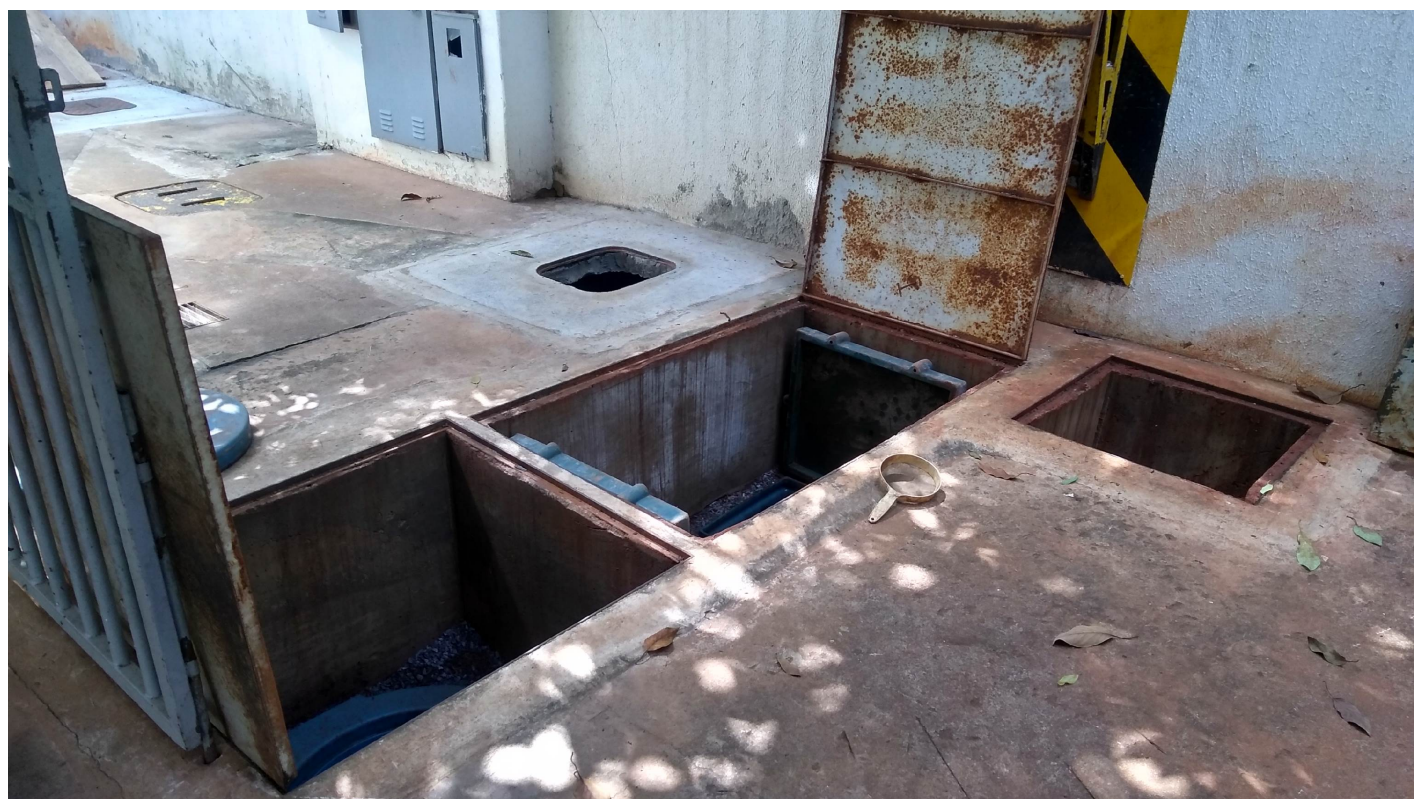
Figura 14 - Sistema separador água e óleo (SAO)
