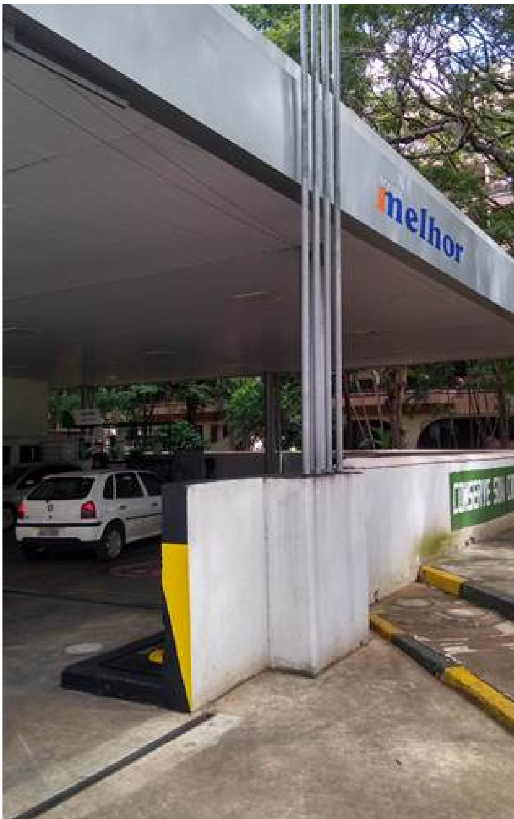
Figura 7 - Respiros dos tanques com terminal corta-chamas
