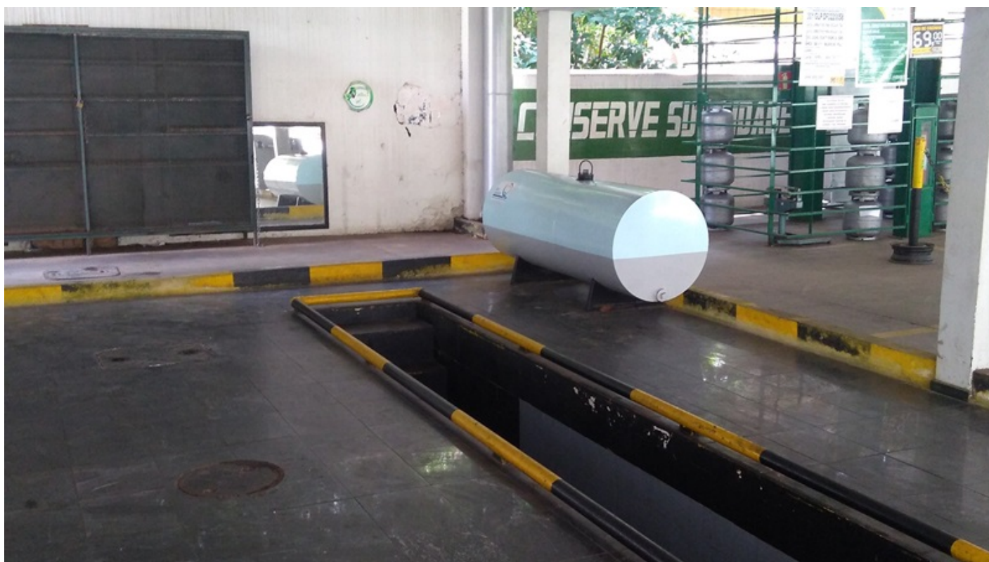
Figura 12 - Tanque de armazenamento de OLUC.
