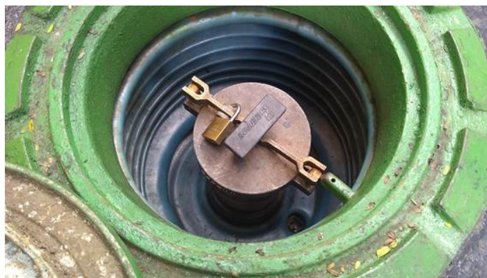
Figura 9 - Descargas à distância com câmara de contenção ( spill container ).
