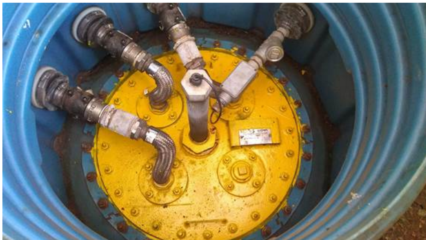
Figura 2 - Boca de visita com câmara de contenção ( Sump de tanque).
